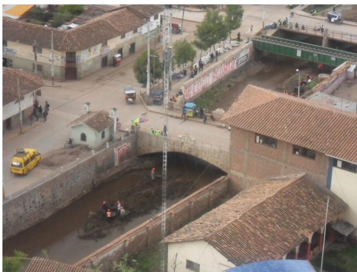
Problemas de encausamiento y protección por acción erosiva cauce del río Cachimayo
