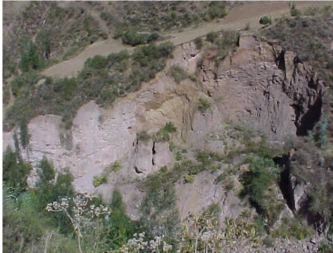
Foto 4: Deslizamiento activo Zona D, con escarpas recientes, que confirman su reactivación.
