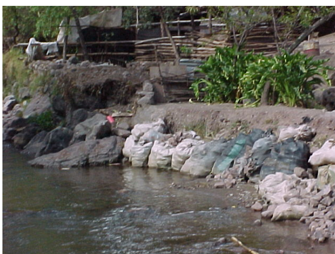
Foto 3: Vivienda afectada por el aluvión del 2003, en la margen izquierda del río Cochoc.
