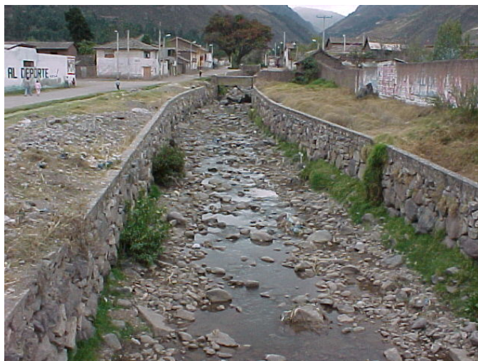
Foto 19: Encauzamiento del río Cochoc (avenida Ucayali) entre las avenidas San Martín y Vilcanota, sin mantenimiento de su cauce.
