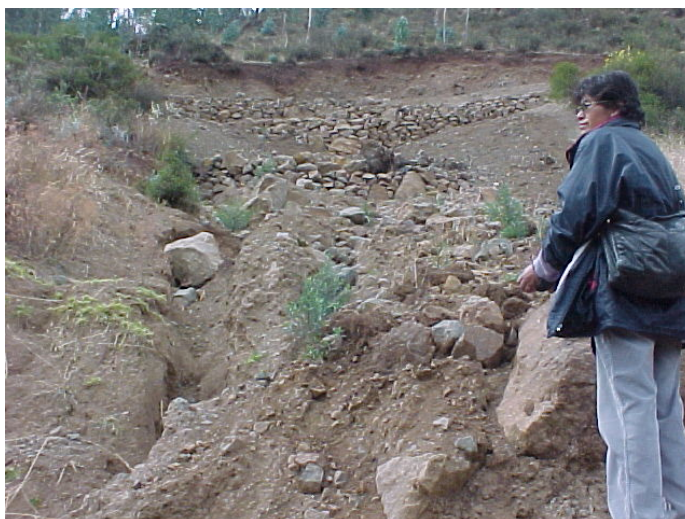
Foto 12: Deslizamientos locales ocasionados por desfogue del denominado Canal Inca.
