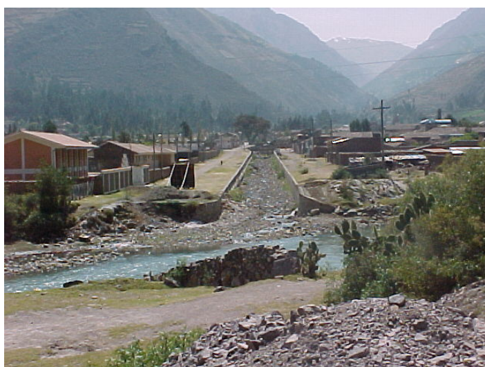
Foto 22: Tramo final del encauzamiento del río Cochoc, mostrando además parte del encauzamiento del río Vilcanota.
