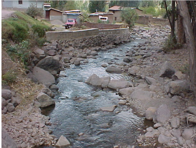
Foto 18: Cauce del río Cochoc con invasión de la faja marginal, mostrando además muros de protección provisionales.
