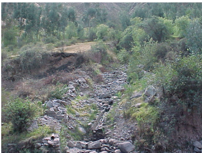
Foto 1: Cárcava activa C-1 en la quebrada Ancahuachana. El aluvión del 2003 destruyó su encauzamiento.
