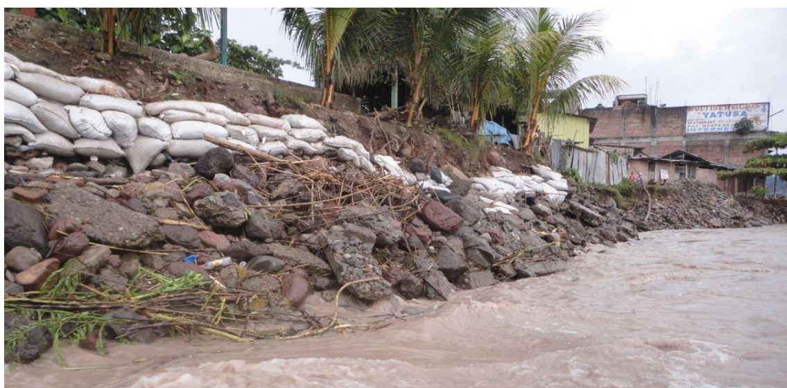
Foto 13.-Defensa ribereña conformada por sacos de arena y arrimado de material (desmante).
