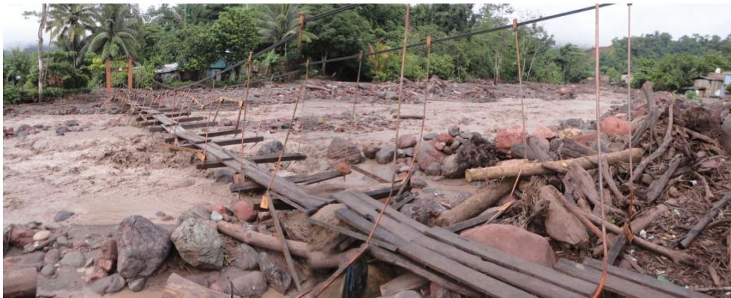
Foto 24.- Puente peatonal parcialmente destruido.
