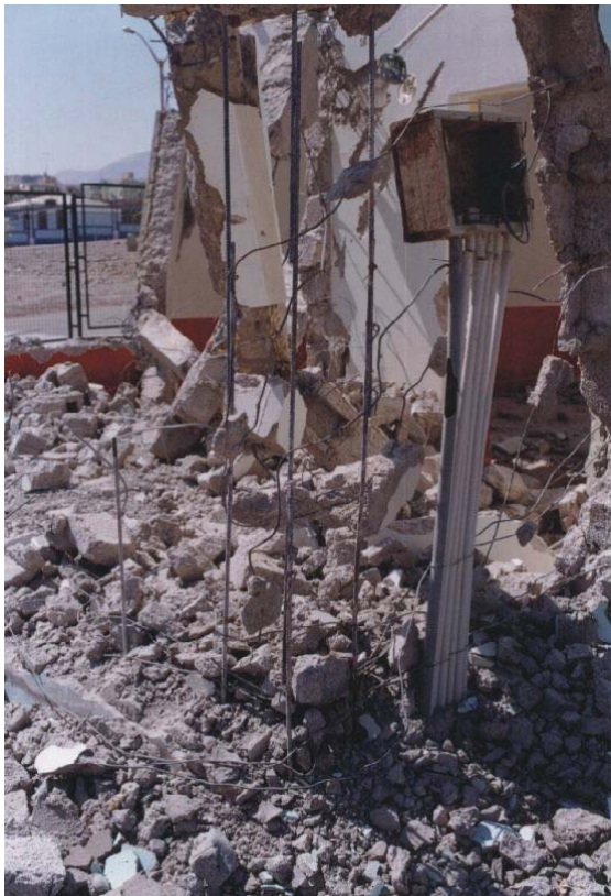
Foto N° 10: Vista parcial del Centro Educativo Inicial San Antonio colapsado (deficiencias en el proceso constructivo)
