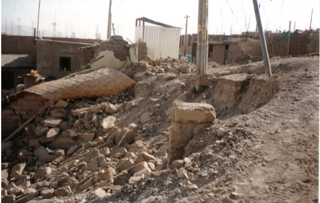
Foto N° 15. Cerro San Francisco: Deslizamiento de talud por pérdida de fricción en suelos.
