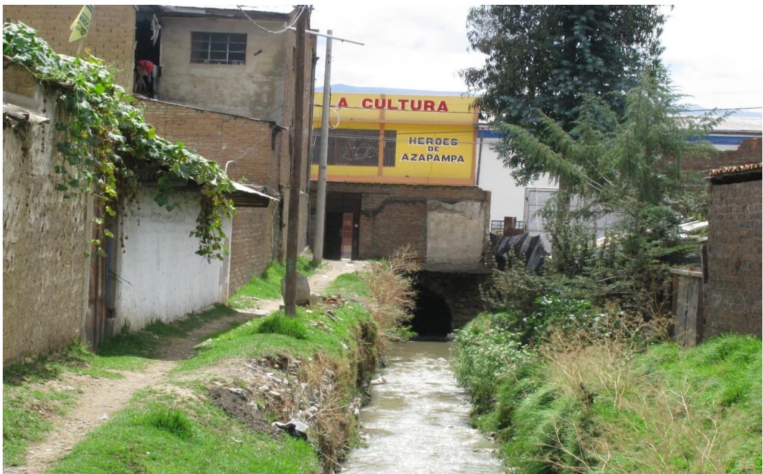
Foto N° 19: Río Chilca atravesando la calle Real por un ducto cerrado (alcantarilla)
