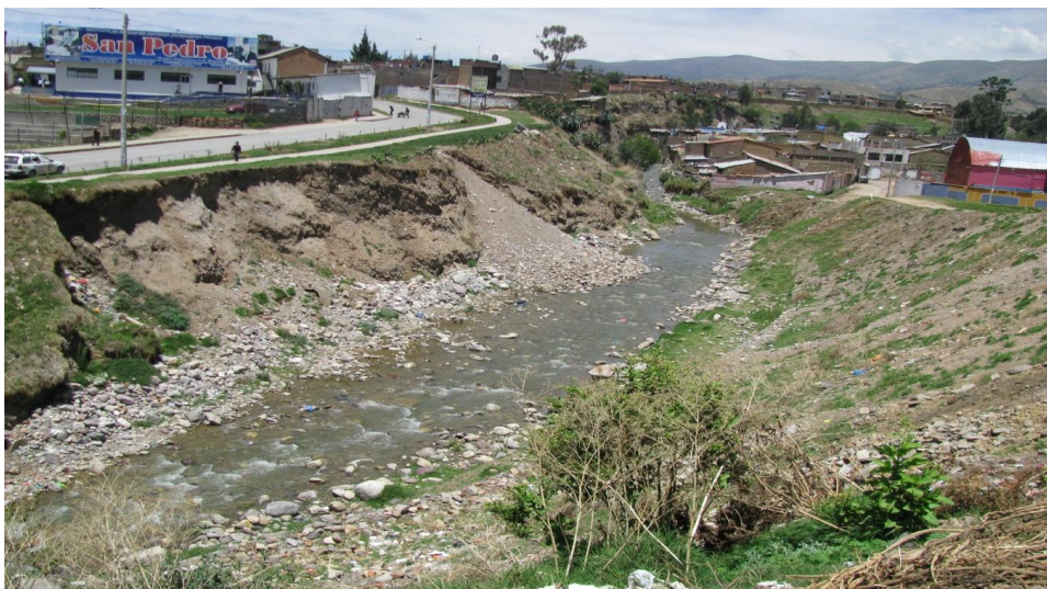
Foto N° 09: Desestabilizaciones del talud en el cauce del río Shullcas, aguas arriba del Puente Wankas
