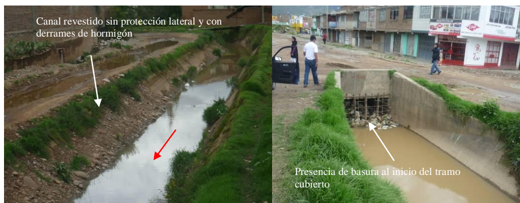
Izquierda , Canal CIMIRM, en el sector del Tambo, con presencia de arrojado de material de hormigón, restando capacidad de conducción.
