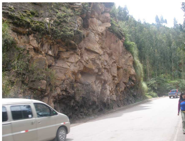
Figura N° 18 Formación Huancané, carretera Cusco - Písaq. 01 km antes de Huancalle, nótese el fracturamiento
