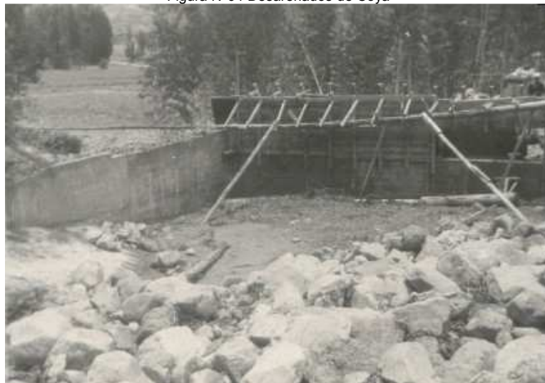
Figura N°64 Desarenados de Coya
