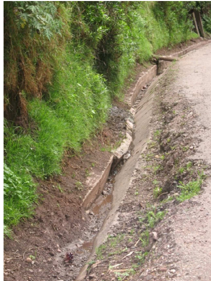
Figura N° 34 empuje del cuerpo del deslizamiento afectando la cuneta existente en la carretera
