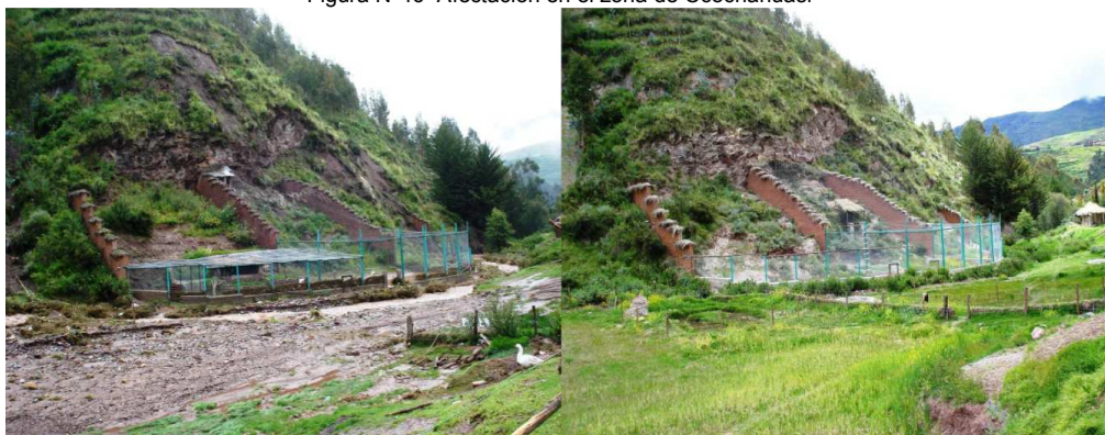
Figura N°46 Afectación en el zona de Ccochahuasi
