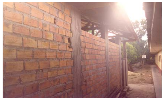
F-13: Edificación construida con ladrillos de arcilla, columnas, pero sin vigas de amarre -calle 20 de abril cuadra 3- (sector Calvario)
