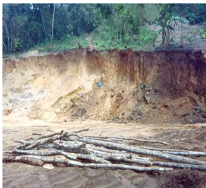
F-5: Talud que rodea esta zona, se observa la erosión del suelo arenoso (sector Calvario)
