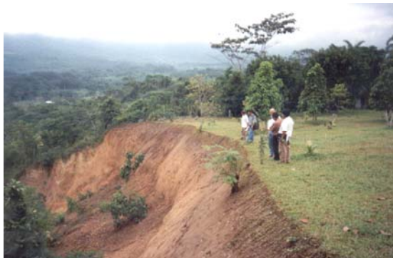
F-10: Deslizamiento en borde del Puerto Mirador (Sector Zaragoza)
