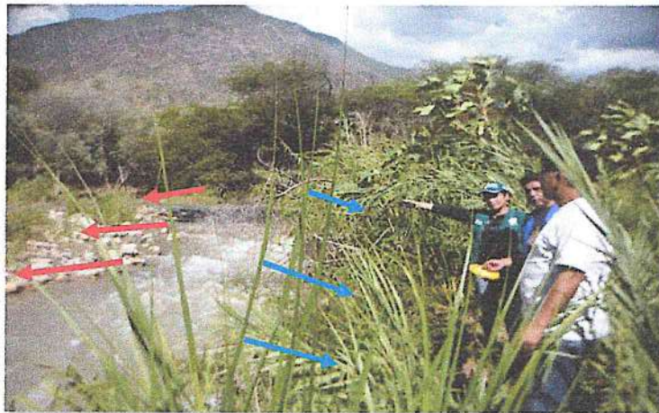
FOTO 1. TRAMO DEL RIO PUSAC EN EL CASERIO HUANABAMBA IDENTIFICADO COMO ZONA CRITICA, EN LA IMAGEN SE NOTA CLARAMENTE EL DEBILITAMIENTO DE LOS TALUDES.
