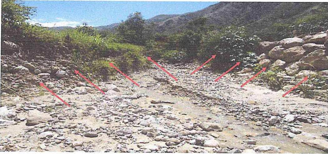
FOTO 2. QUEBRADA LONGOTEA COMPLETAMENTE COLMATADA Y REBERAS DESPROTEGIDAS
