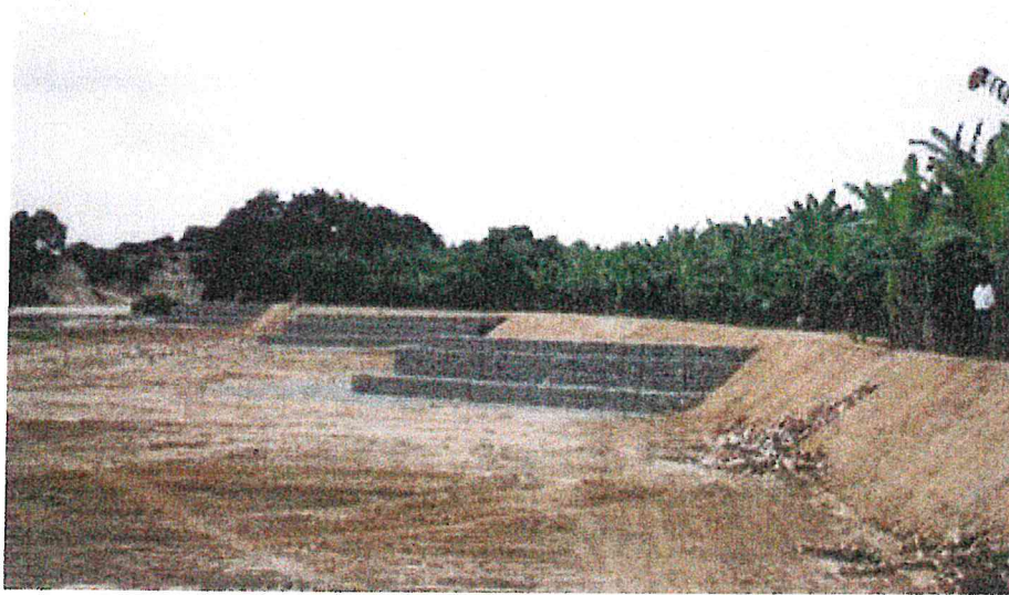
Imagen N° 10: Protección con espigones de gaviones
