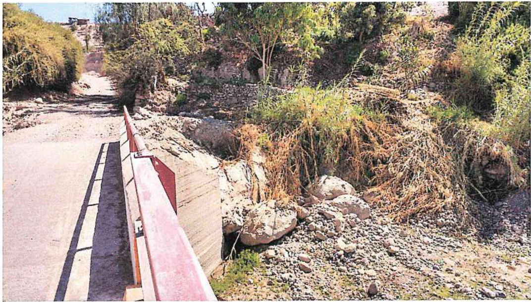
VISTA 3.- PUENTE MONTALVO ANTIGUO, PRESENTA SOCAVAMIENTO DEL MURO DE PROTECCION EN LA MARGEN DERECHA.
