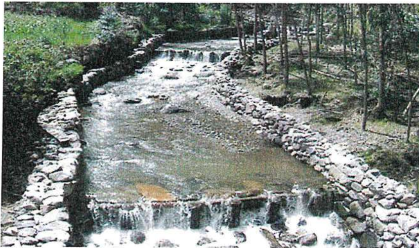
Imagen N° 13: Disipadores de energía en operación ante avenidas
