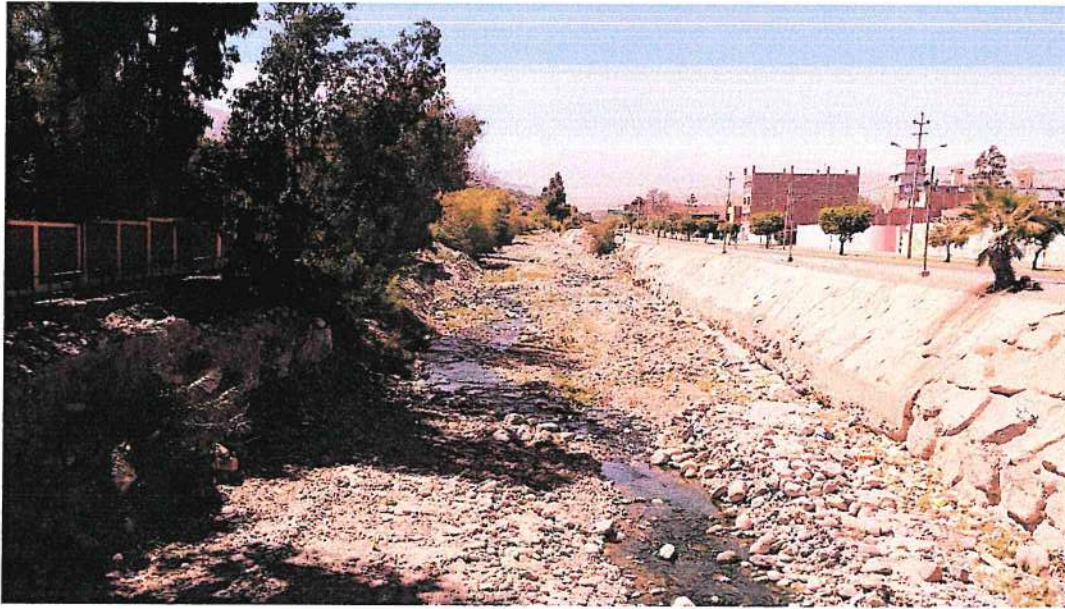
VISTA 5.- CAUCE DEL RIO TUMILACA ALTURA DEL PUENTE LA VILLA PRESENTA SOCAVAMIENTO DE OBRAS DE DEFENSA RIBEREÑA, QUE PONEN EN RIESGO LA INTEGRIDAD DE LA ESTRUCTURA
