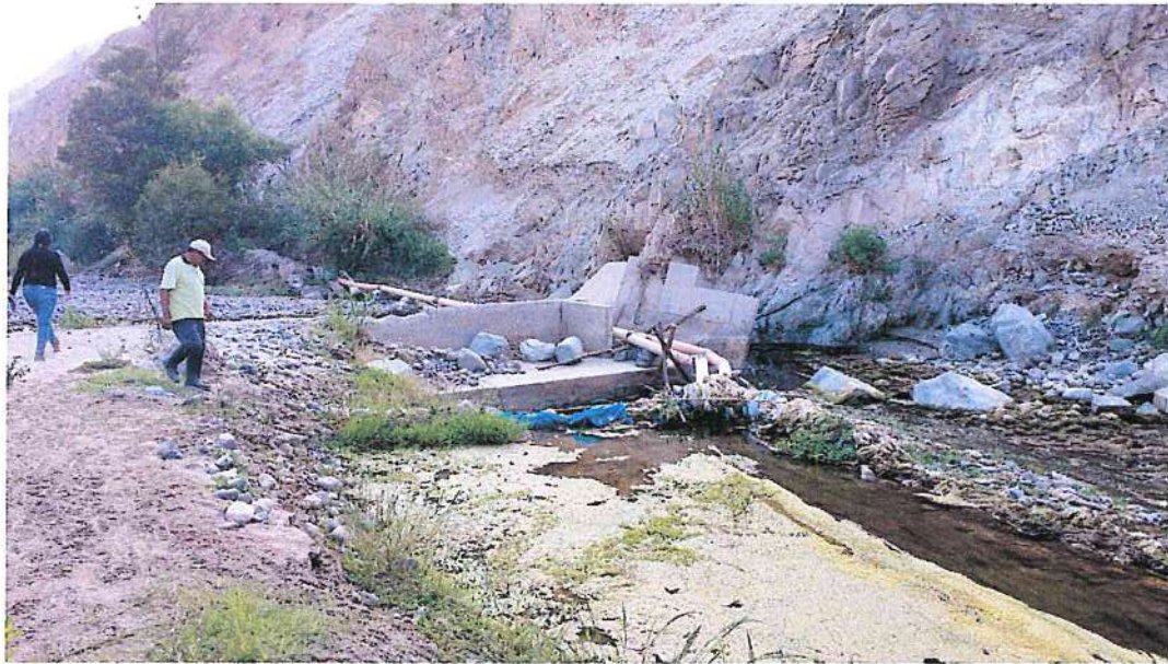
VISTA 5.- BOCATOMA DE CONCRETO (EL ALGARROBAL) PRESENTA COLAPSO DE COMPUERTA DE LIMPIA Y VENTANA DE CAPTACIÓN.
