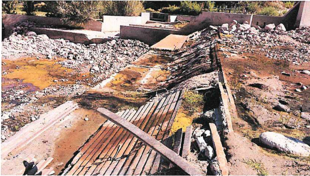
VISTA 1.- DAÑOS EN EL BARRAJE DE LAS BOCATOMAS DE CHIRILO Y CHARSAGUA, CAUCE DEL RIO TUMILACA; PONE EN RIESGO ESTRUCTURA DEL SIFON DEL CANAL PASTO GRANDE, POR SOCAVAMIENTO.
