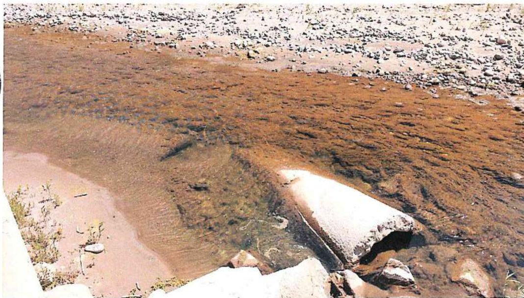
VISTA 2.- ANILLOS DE CONCRETO COLAPSADOS , EN EL CAUCE DEL RIO A CONSECUENCIA DE ARRASTRE POR LAS AVENIDAS.
