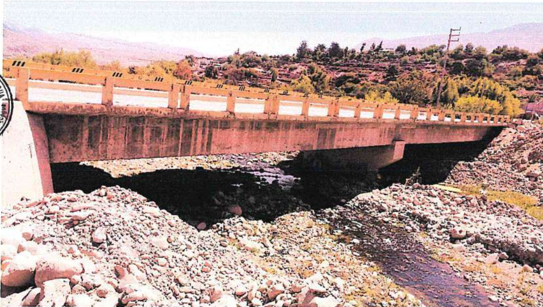
VISTA 6.- CAUCE DEL RIO TUMILACA, ALTURA DEL PUENTE EL RAYO, PRESENTA COLMATAMIENTO DE CAUCE, PONE EN RIESGO DE DESBORDE QUE AFECTA PREDIOS DE CULTIVO Y PARTE BAJA DE LA CIUDAD DE MOQUEGUA.
