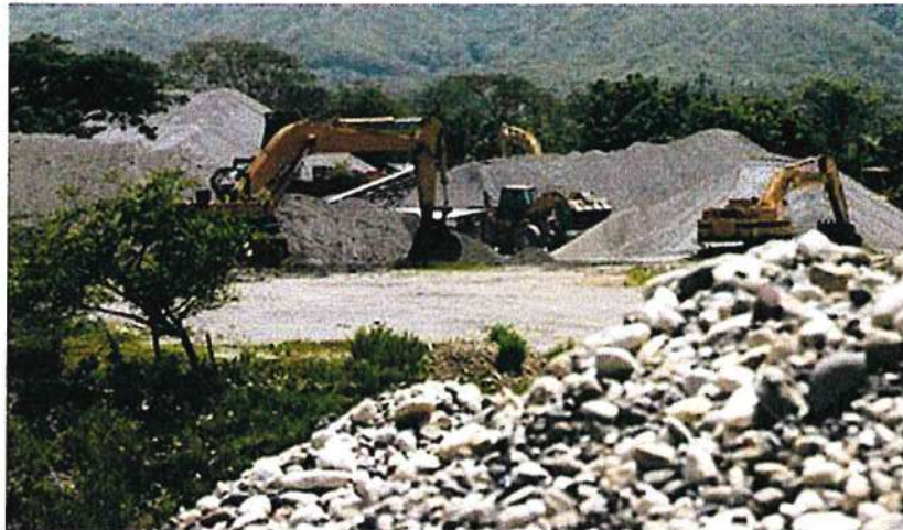
Imagen N° 02: Extracción de material de acarreo descontrolado en el río Vilcanota
