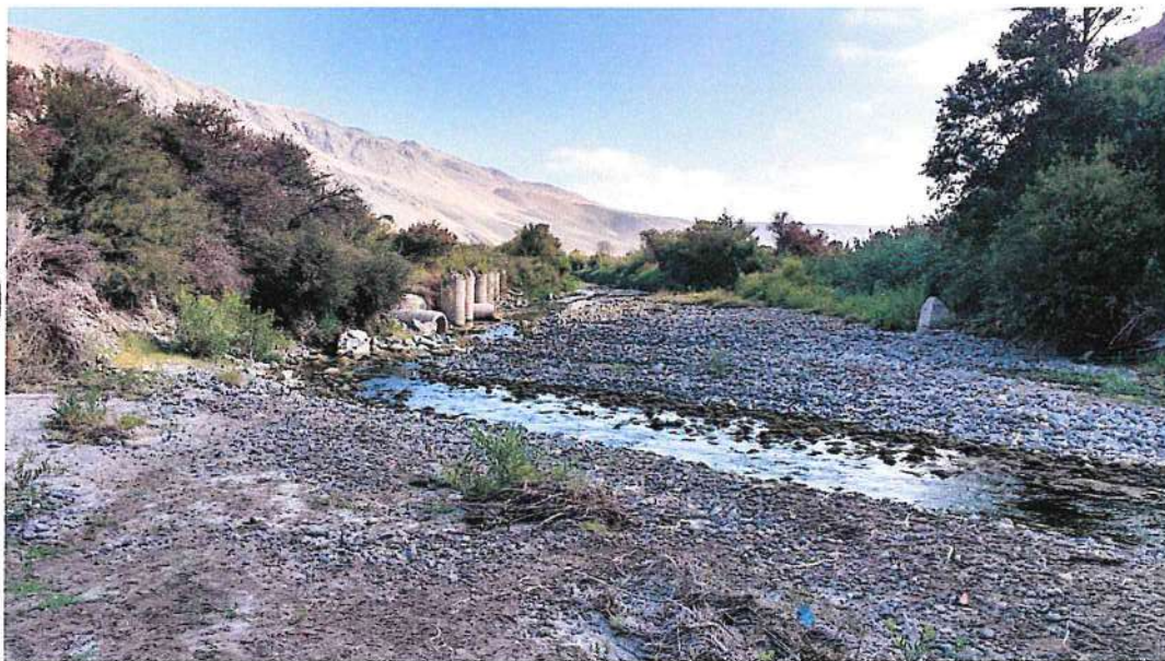
VISTA 6.- ANILLOS DE CONCRETO COLAPSADOS, EN LA MARGEN DERECHA DEL RIO ILO.
