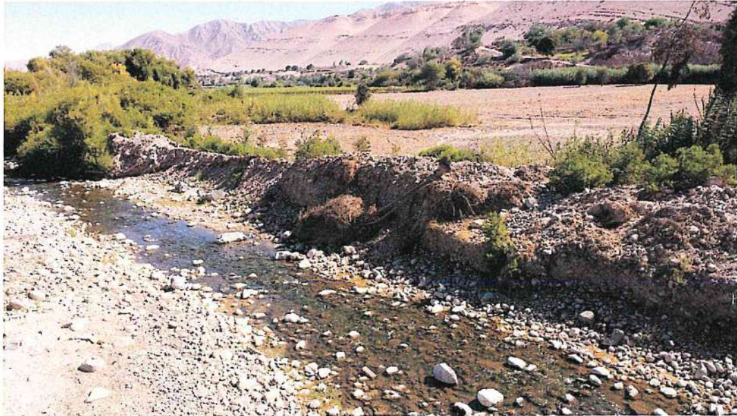
VISTA 5.- EL CAUCE PRESENTA SOCAVAMIENTO DE LA RIBERA EN LA MARGEN DERECHA Y PONE EN RIESGO DE INUNDACION A PREDIO AGRICOLA.
