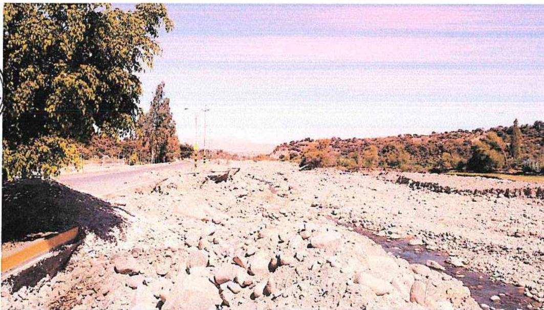
VISTA 4.- CAUCE DEL RIO TUMILACA ALTURA DEL SECTOR ESCAPALAUQUE, PRESENTE DESBORDAMIENTO Y COLAPSO DE UNA VIA DEL MALECON RIBEREÑO.
