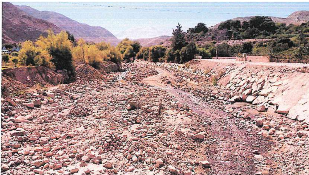
VISTA 2.- DAÑOS POR SOCAVAMIENTO EN EL MURO DE MAMPOSTERIA DE LA MARGEN DERECHA DEL RIO TUMILACA SECTOR TUCUMAN DEL MALECON RIBEREÑO
