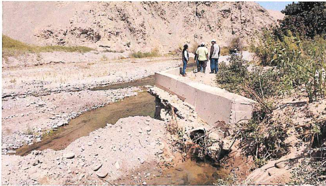
VISTA 1.- ESTRUCTURA DE PROTECCIÓN DE LA BOCATOMA DE CANUTO DE LA EPS ILO AFECTADA POR SOCAVAMIENTO.
