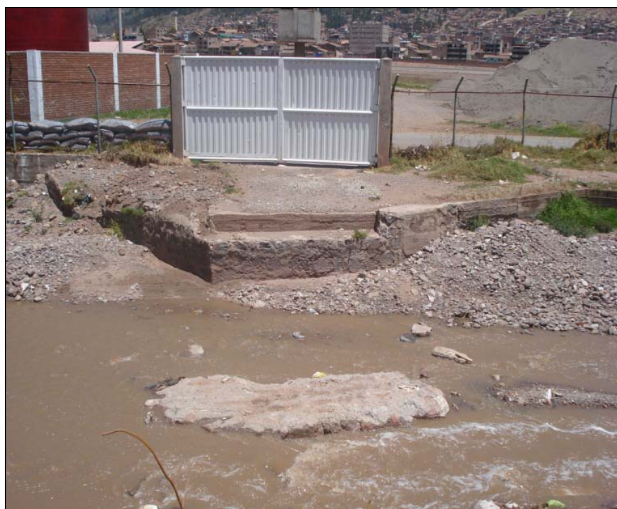
Fig. 6: Lugar donde se ubicaba el puente CORPAC, que posteriormente fue levantado por constituir la zona de inicio de desborde del río Huatanay.
