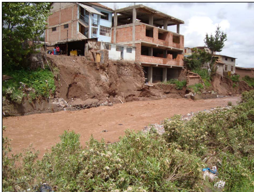
Fig. 10: Observamos casas de hasta 4 pisos construidas sobre obras de defensa ribereña. Estas colapsaron con los eventos de enero.
