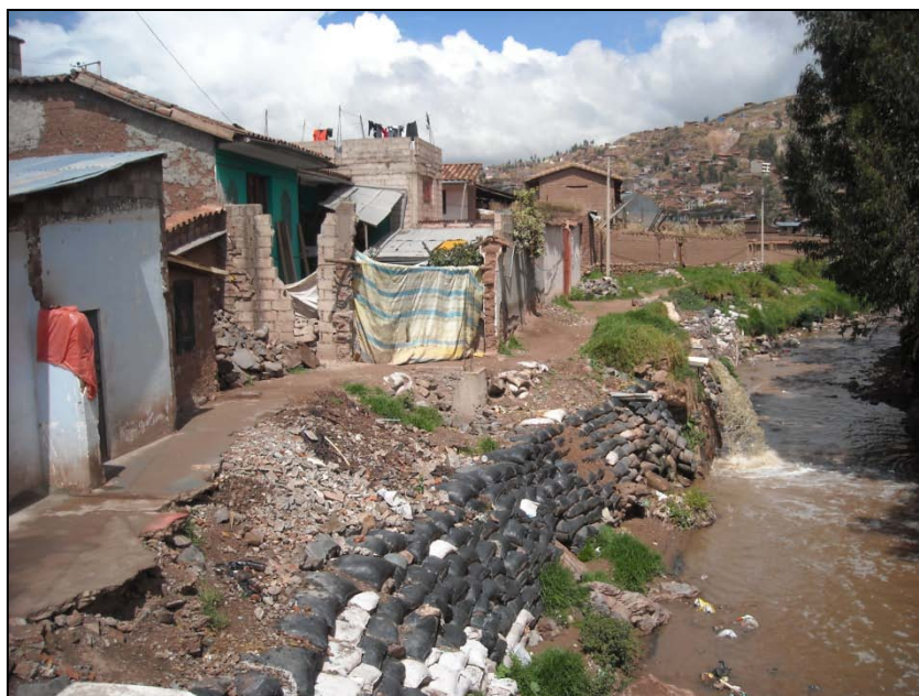
Fig. 11: Gaviones colapsados y reemplazados temporalmente por costales de arena. Nótese las viviendas afectadas.
