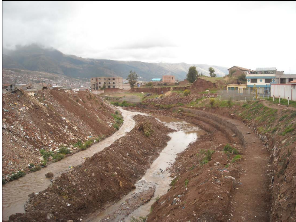
Fig. 3: Fotografía mostrando el río Huatanay colmatado, además el sistema de gaviones colapsados en la margen derecha y a la izquierda se aprecia el desmonte que es vertido al río, desmonte que afecta el cauce normal del río.
