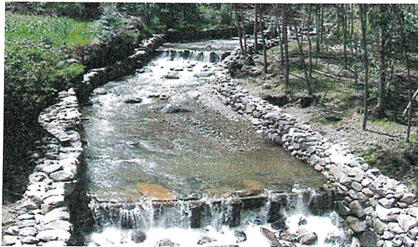
Imagen N° 13: Disipadores de energía en operación ante avenidas
