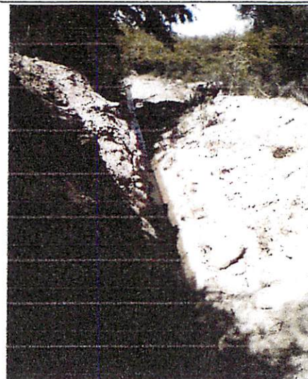
Canal La Huarca, vulnerable a ser tapado
