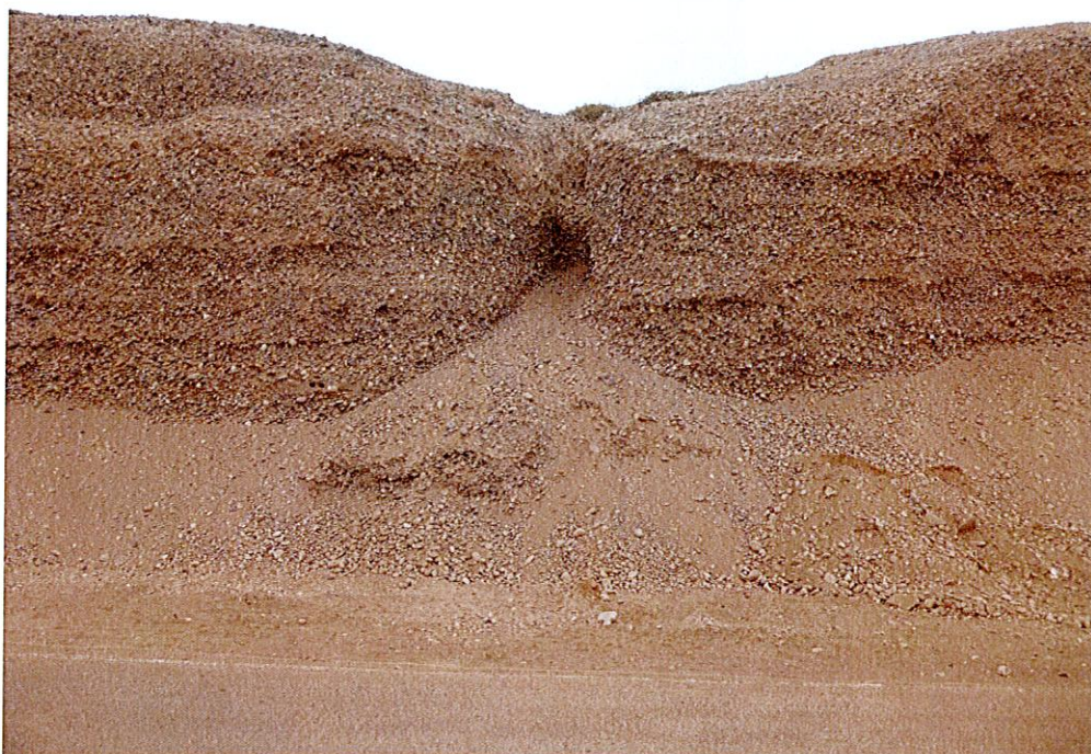
Foto 14: En el talud superior de la Av. Chorrillos, también se generan cárcavas por la presencia de terrenos de cultivo en la parte alta del talud, cuyas aguas de regadío eventualmente discurren sobre el talud generando incisiones las cuales forman zanjas. (A-002).
