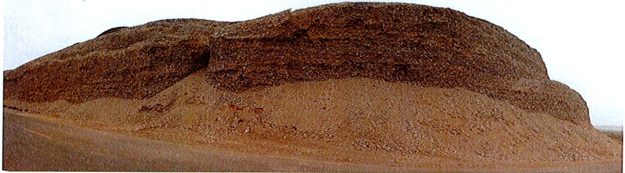
Foto 10. Vista panorámica de los derrumbes en el talud superior de la Av. Chorrillos en el Balneario de Barranca.
