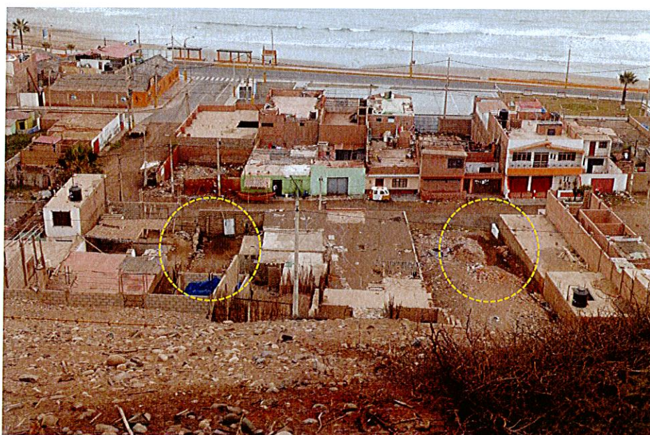
Foto 23: En la parte inferior de la carretera se observa, con tonalidad oscura, la humedad presente en paredes de algunas viviendas. En estos sectores se observa también una ligera capa de tonalidad clara correspondiente a la presencia de sales. Estas sales son elementos químicos agresivos a cualquier estructura asentada en este suelo, y la base de las viviendas presenta el deterioro lento por dichas sales.
