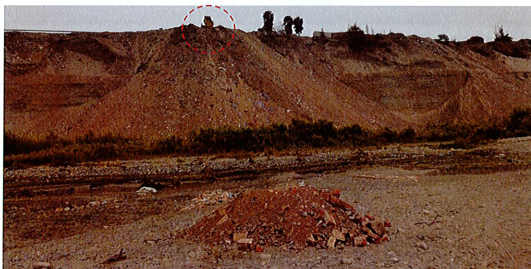
Foto 13: En el círculo rojo, se identifica un camión arrojando material de desmonte, el cual aportan más material al cauce del río Pativilca, y contribuye a la inestabilidad del talud, en el sector La Garita.
