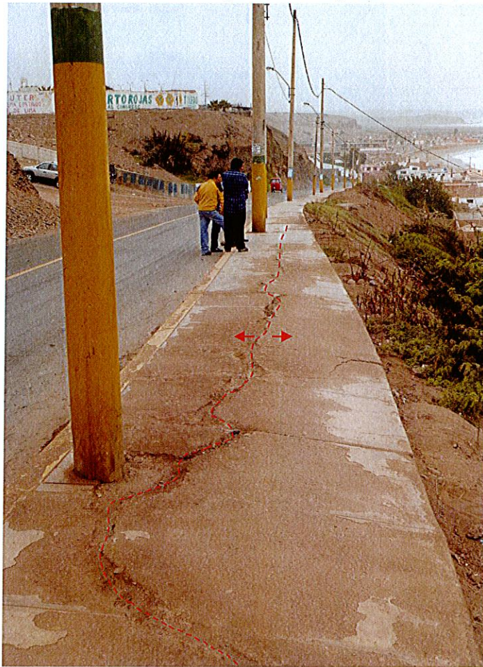
Foto 19: Vista donde se observa la presencia de grietas de 4 cm de ancho y 30 m de longitud verificado en la inspección de campo.
