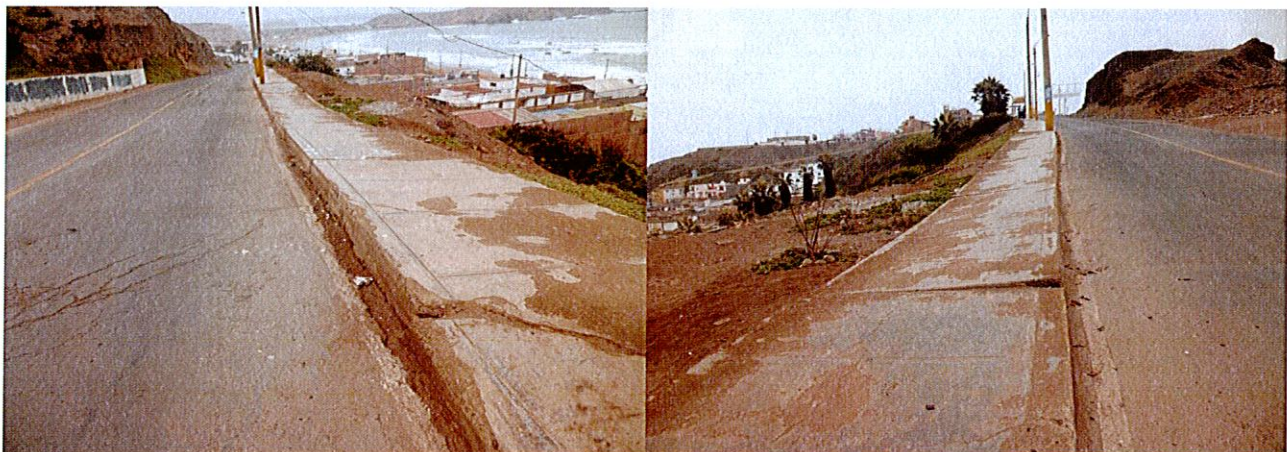
Foto 20: Presencia de grietas en la vereda de 12 a 14 cm de ancho y 8 cm de asentamiento. Algunos postes se encuentran inclinados. En ambas imágenes se observa el desnivel de la vereda.
