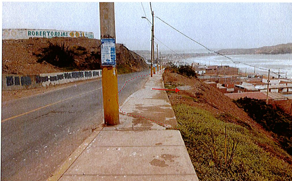
Foto 21: Carretera Barranca-Puerto Chico, presenta asentamientos y agrietamientos en plataforma inferior de la carretera hacia el balneario de Barranca con dirección SO.
