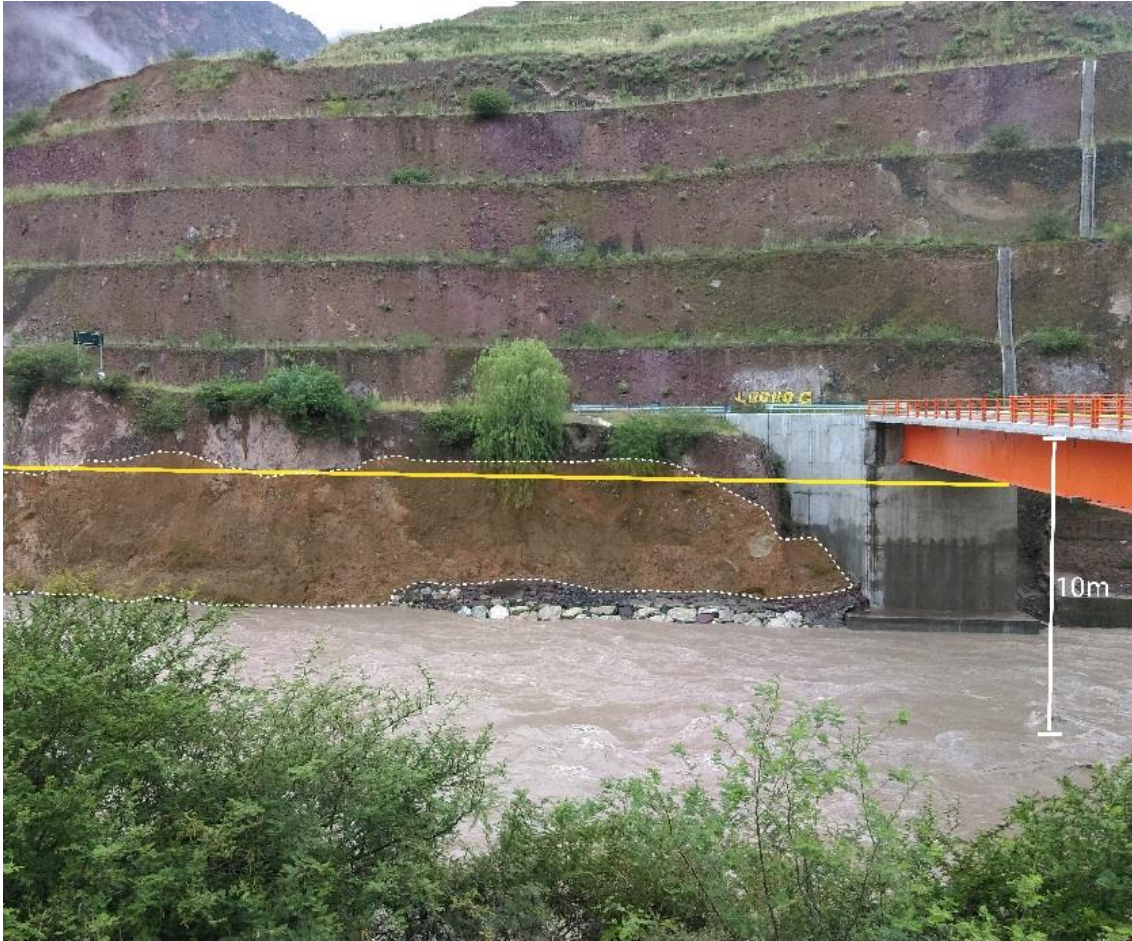
Foto 6. Erosión de fluvial y nivel del embalse (línea amarilla) del día 25 de marzo. El agua llegó a medio metro por debajo del puente. En la zona se observan laderas erosionadas (polígono rodeado por línea blanca).
