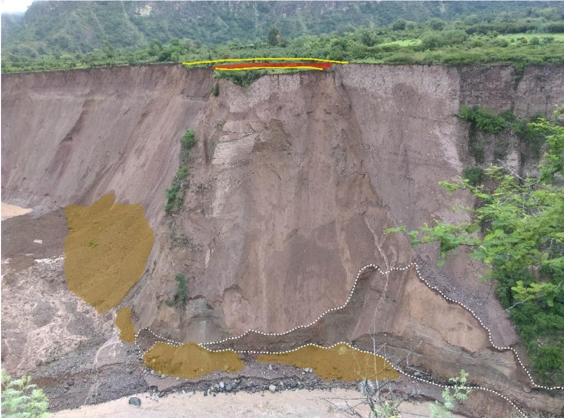
Foto 9. Material colgado presentando desplazamiento (polígono rojo) y agrietamientos (líneas amarillas) en la parte superior. La base del talud muestra erosión por socavamiento fluvial (línea blanca) y material recientemente colapsado (polígonos marrones).
