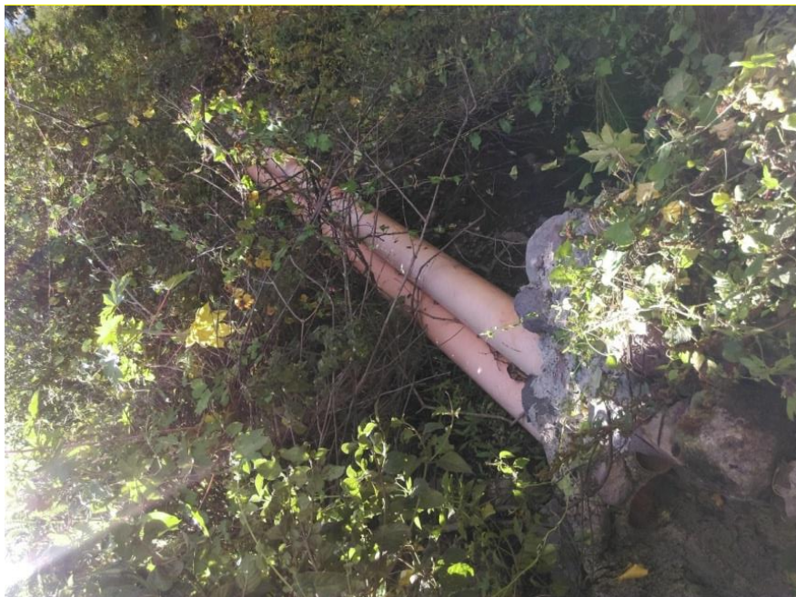
Foto 11. Canalización entubada por deterioro del canal. La zona presenta agrietamientos de 1 m de ancho y 1.2 m de desplazamiento por debajo los tubos.
