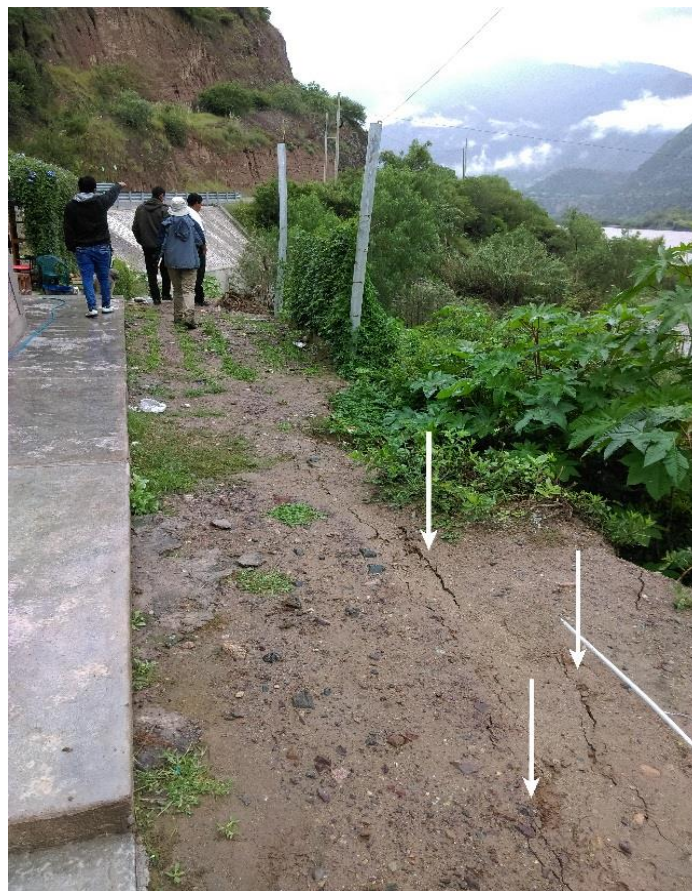
Foto 8. Vista de agrietamientos que comprometiendo el tendido eléctrico en el flanco derecho del cauce del río Pampas.
