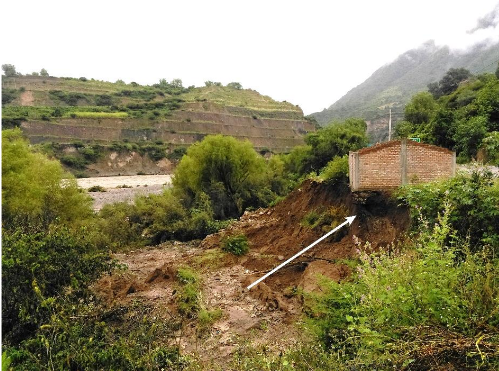
Foto 7. Vivienda colgada a consecuencia de socavamiento fluvial del río Pampas.
