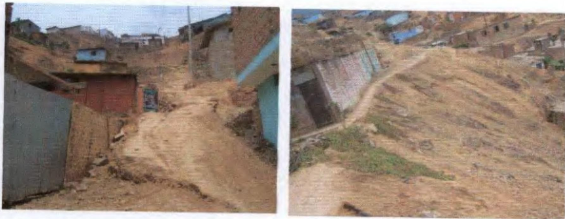
Foto N° 5 y 6. A la izquierda obsérvese la depresión en la manzana D, y a la derecha el cono de material suelto.
