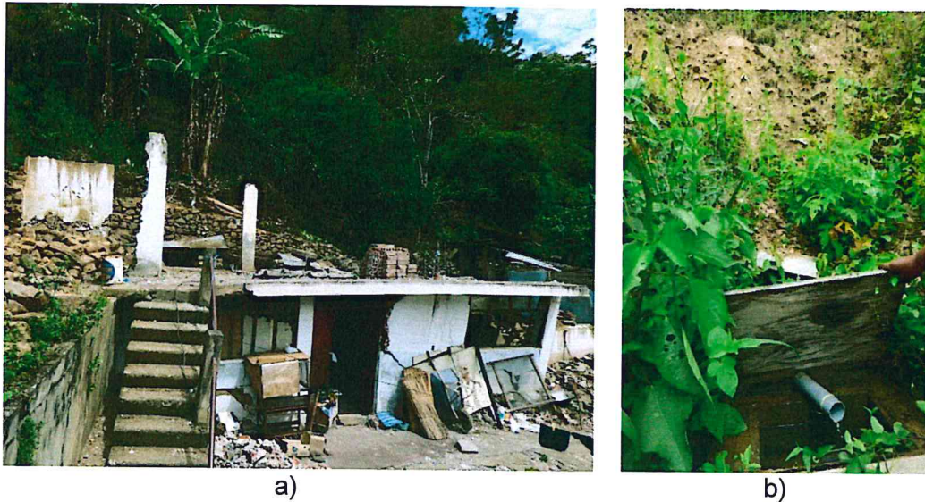
Foto 12. a) Vivienda afectada por reptación de suelos. b) Presencia de agua subterránea en el barrio Curva Alegre.
