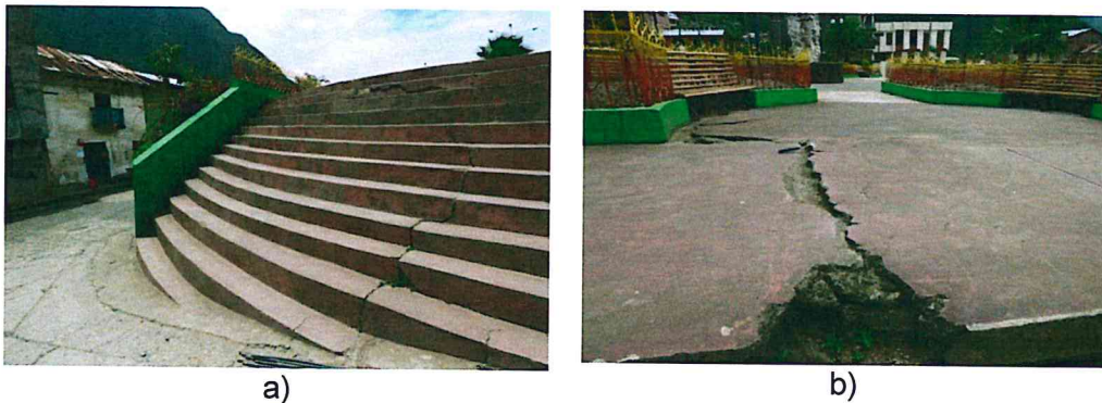
Foto 15. a) y b) Fisuras en el pavimento de la plaza principal de San Juan del Oro.
