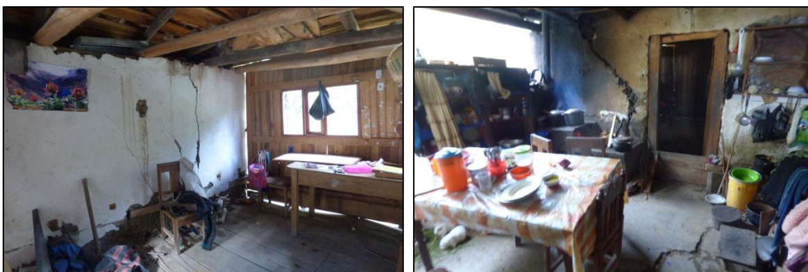
Fotos 9 y 10: Viviendas agrietadas a causa de los deslizamientos activos, en estado de inhabitabilidad.
