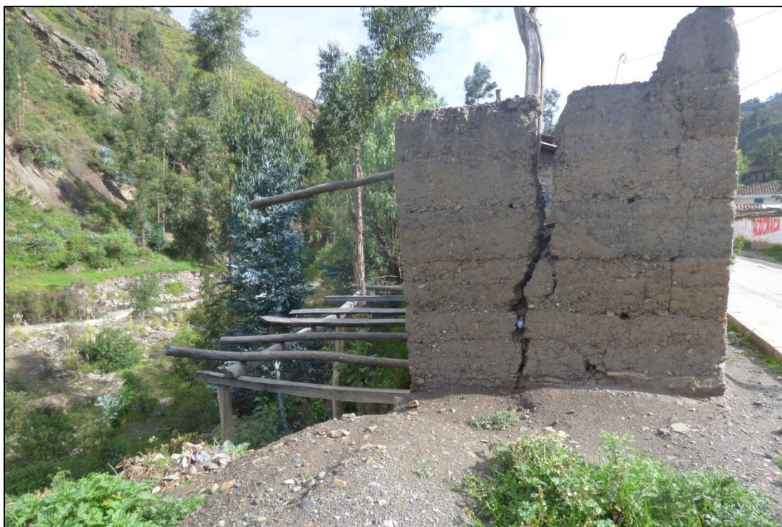
Foto 11: Vivienda ubicada en el borde de una terraza aluvial, y que es afectada durante crecidas excepcionales del río Acochaca.
