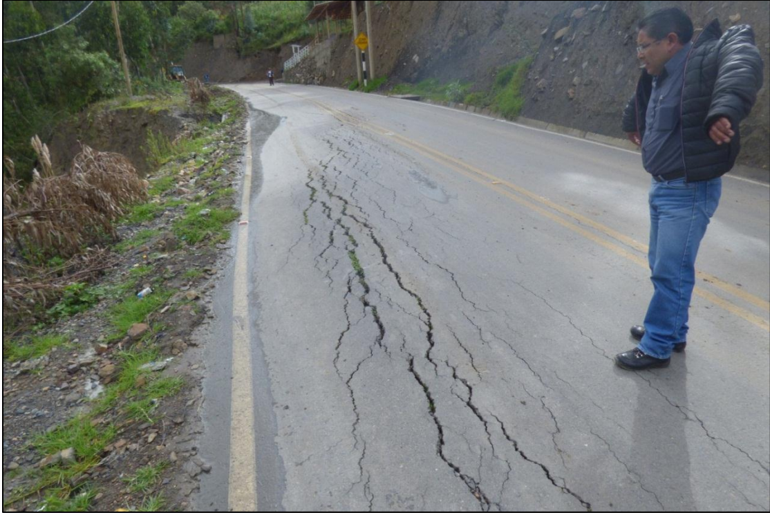
Foto 12: Grietas tensionales en la cabecera de los deslizamientos a la margen izquierda del río Acochaca.
