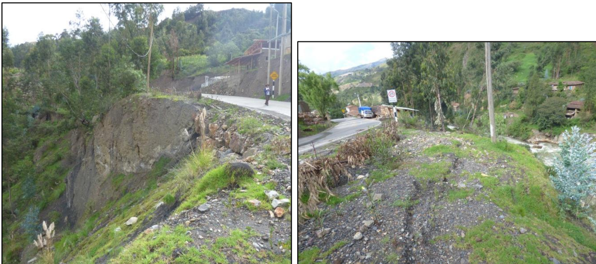
Fotos 5 y 6: Izquierda, escarpe de deslizamiento activo, derecha, grietas y saltos de deslizamiento.
