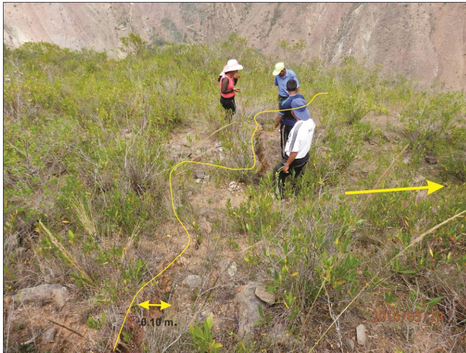
Foto 4. Vista tomada con dirección sur, se observa grieta retrogresiva de abertura 0.10m y una dirección de movimiento norte 238°
