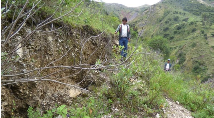
Foto 6. Parte de la escarpa principal del deslizamiento en formación.
