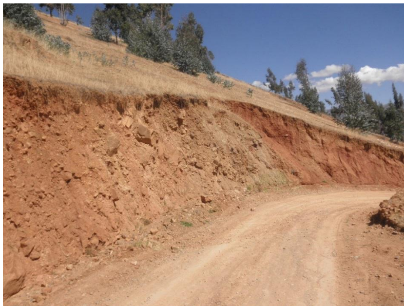
Foto 14. Trazo de la carretera afirmada, el talud corresponde a un depósito coluvio-deluvial, no presenta cuneta para circulación de aguas
