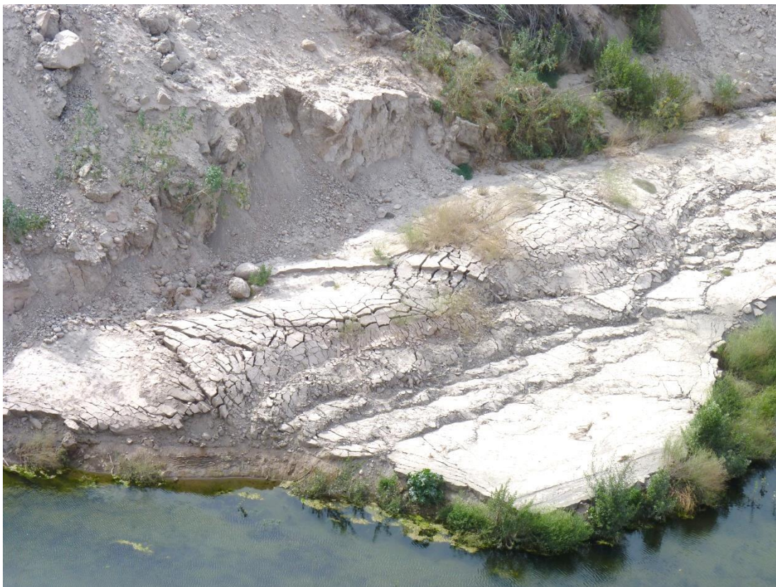
Foto 6: Terraza Fluvial altamente agrietada y destruida.
