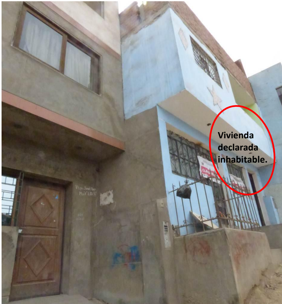
Foto 8. Se aprecia que la vivienda contigua a la vivienda declara como inhabitable, su pared esta resanada, por presentar agrietamiento.
