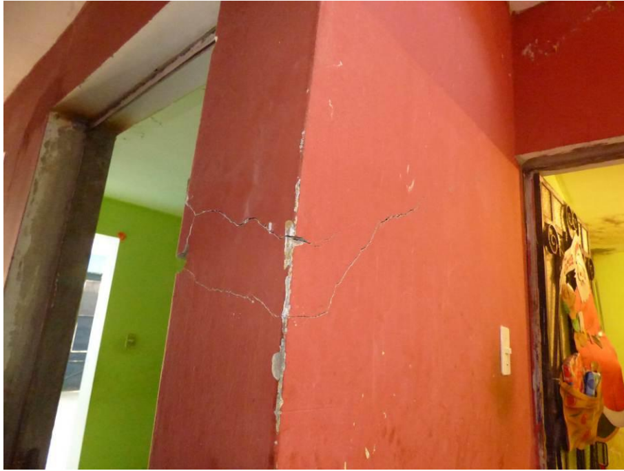
Foto 7. Interior de vivienda afectada por el proceso de hundimiento, se aprecian paredes agrietadas y asentadas
