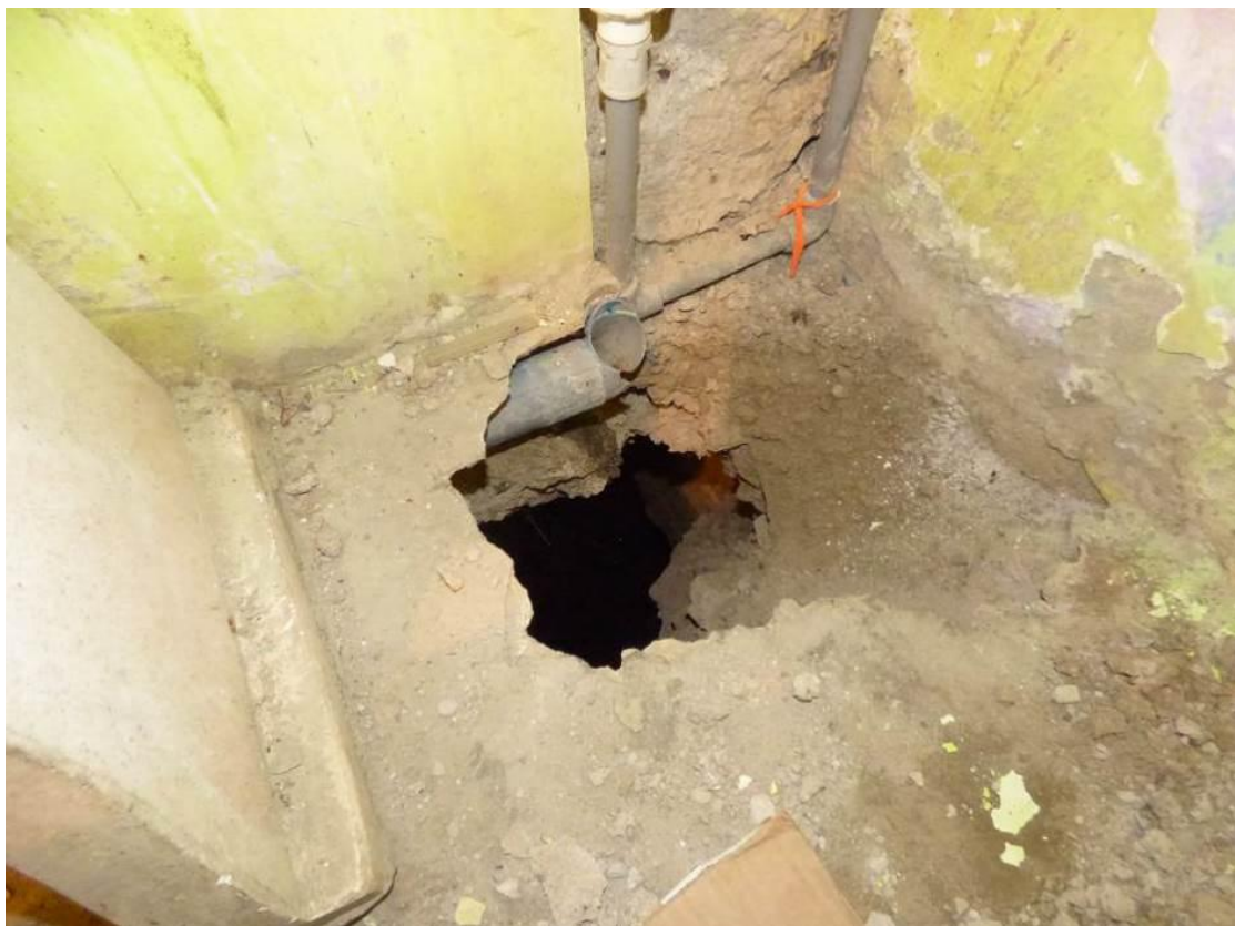
Foto 2. Apertura en el piso por donde se divisó la galería subterránea.
