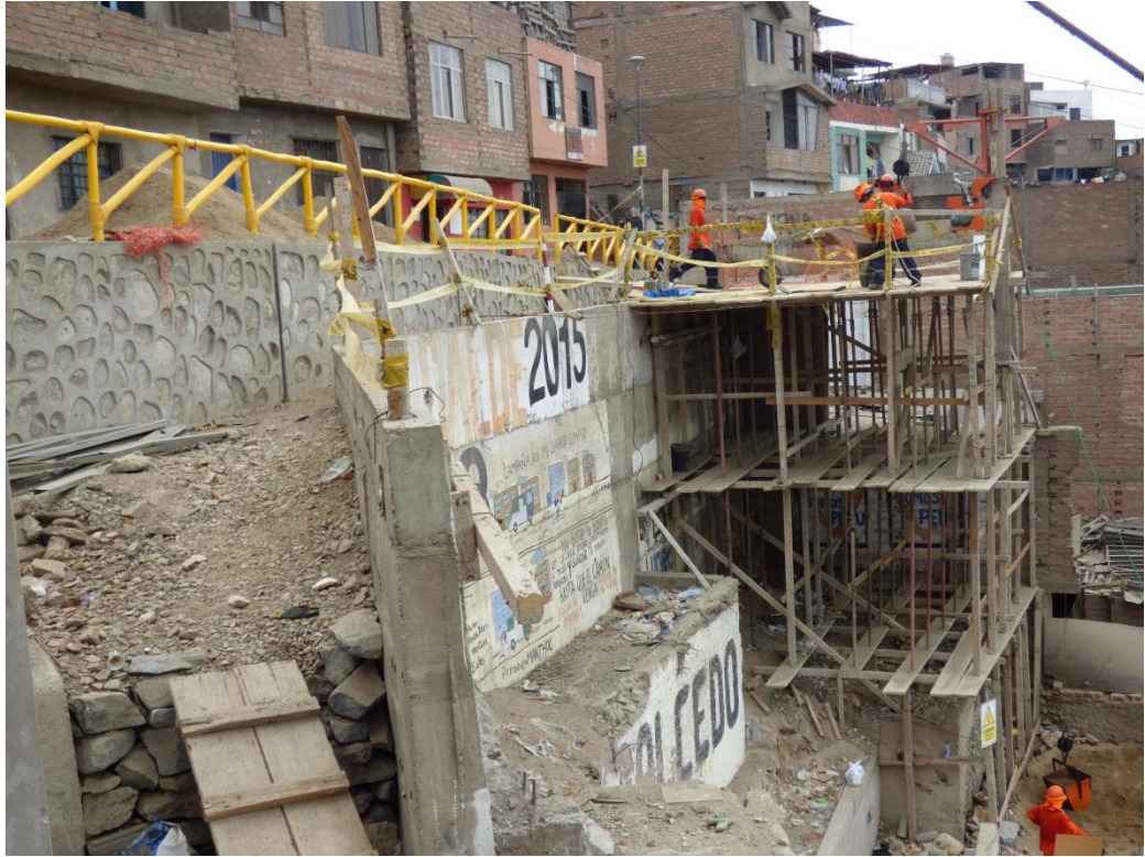
Foto 13. Se aprecia los trabajos de muros de contención y rellenos. El tendido de la línea LT-1 se desplaza por el Pasaje Alfonso Ugarte en la parte superior de las obras.
