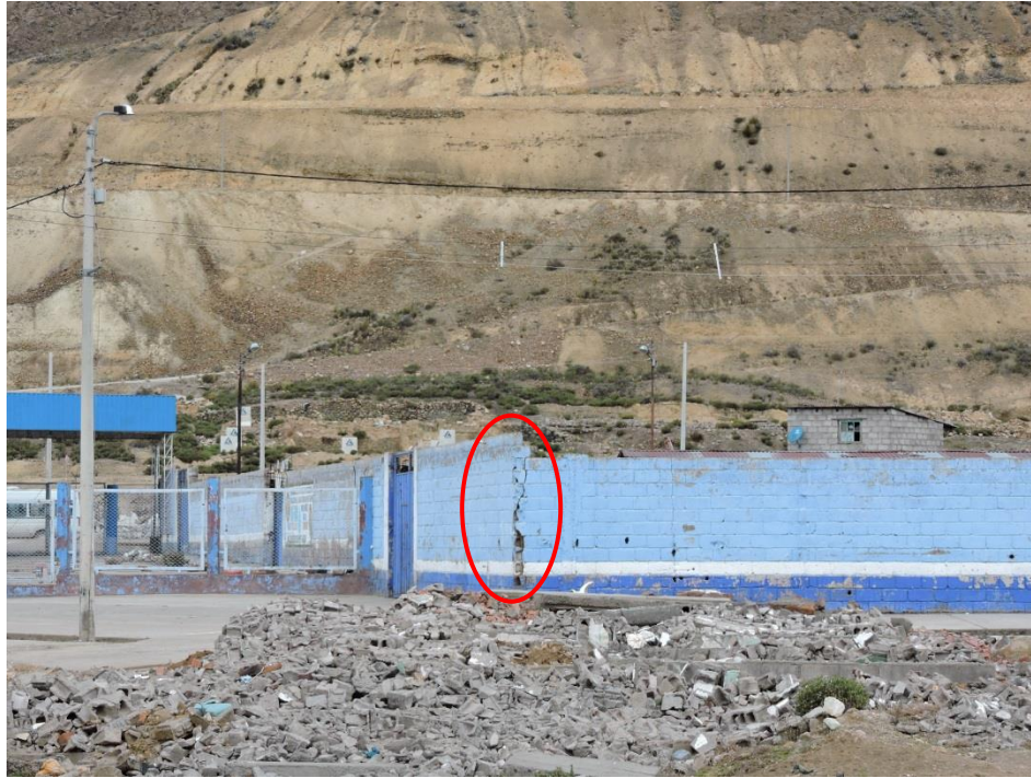
Foto 7. Los muros y juntas del Terminal Terrestre de Morococha antigua presentan fisuras, podrían colapsar y afectar algún morador.
