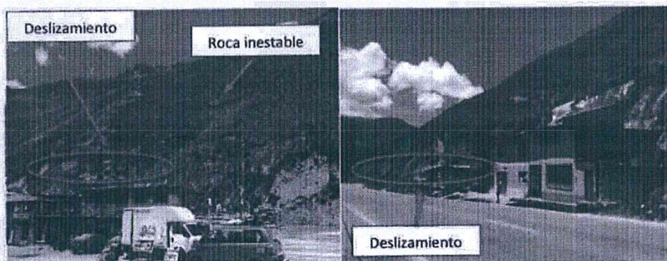
Fotografía 7 Zona de deslizamiento en Barrio Nuevo Progreso, frente al campamento de la Minera Casapalca.
