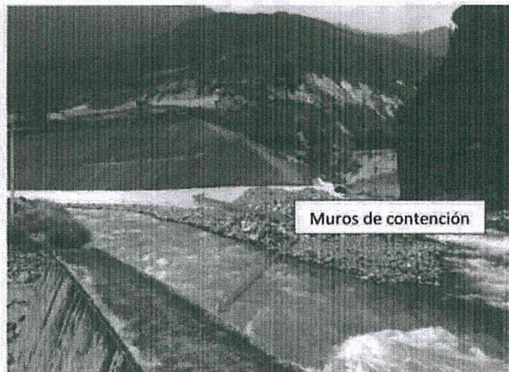
Fotografía 4 Muros de contención en ambas márgenes a la altura de la minera Coricancha. Fuente : INDECI 2018
