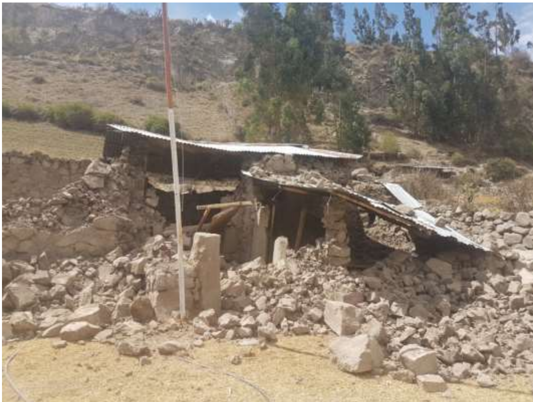
Foto 08: Vivienda colapsada por efecto de la amplificación de ondas sísmicas, el suelo y el tipo de construcción.
