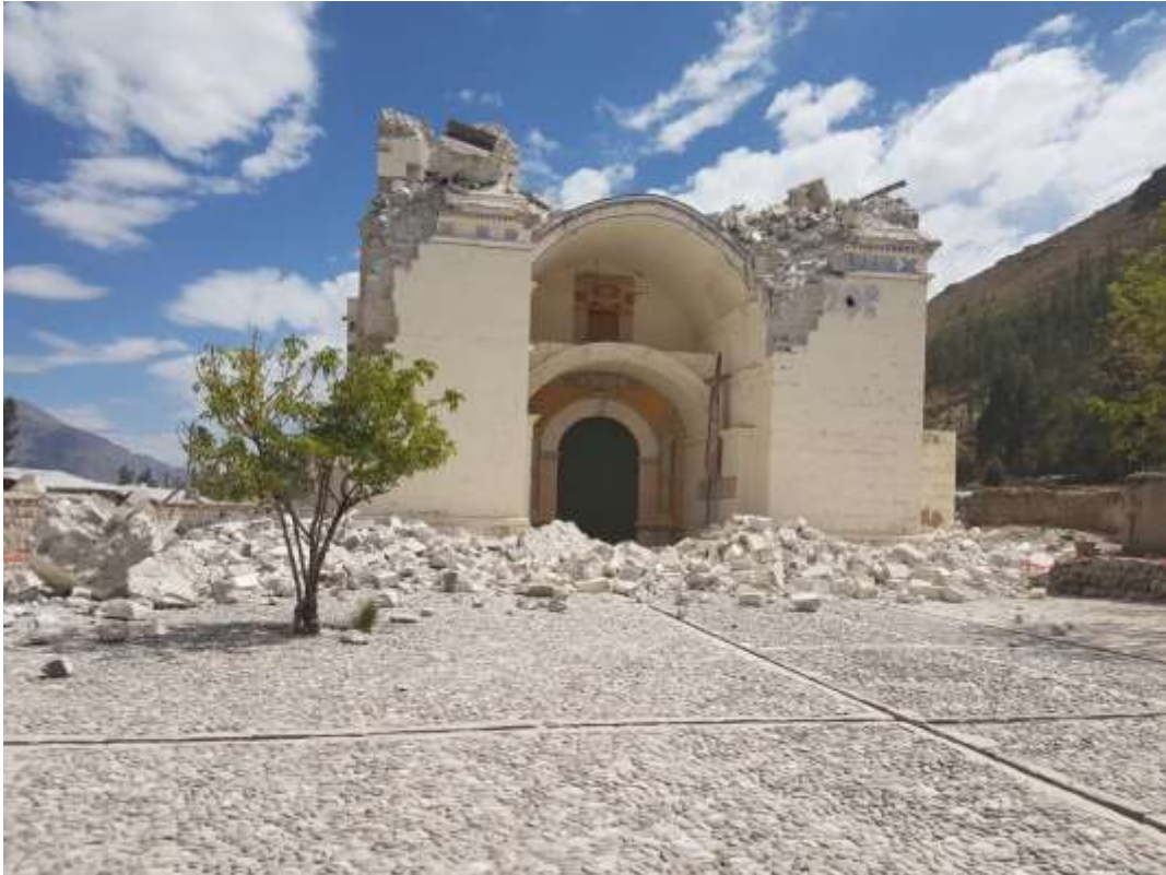
Foto 07: Daños en la iglesia destruida, los campanarios de la iglesia colapsados por efectos del movimiento sísmico.
