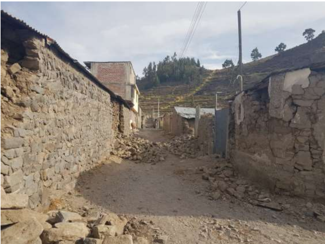
Foto 14: Muros colapsados por efecto de la amplificación de ondas sísmicas, el suelo y el tipo de construcción, nótese la vivienda de material noble que no sufrió mayor daño.
