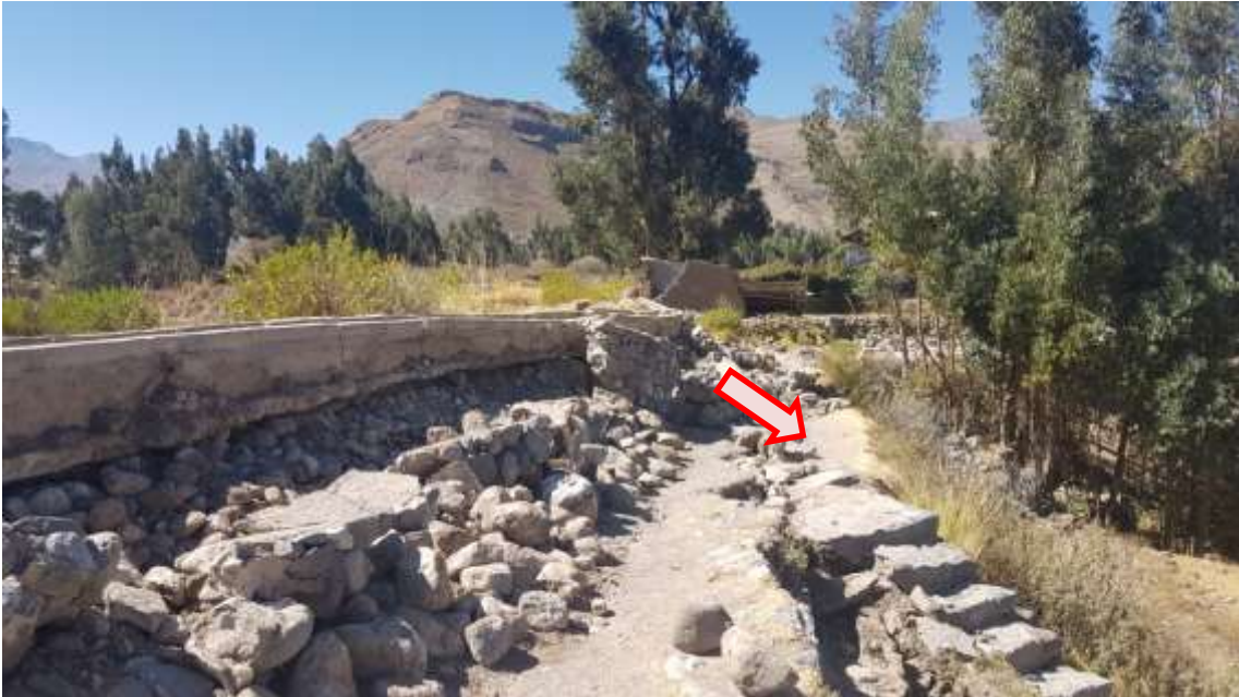
MM11: Deslizamiento afectando el camino y canal.
