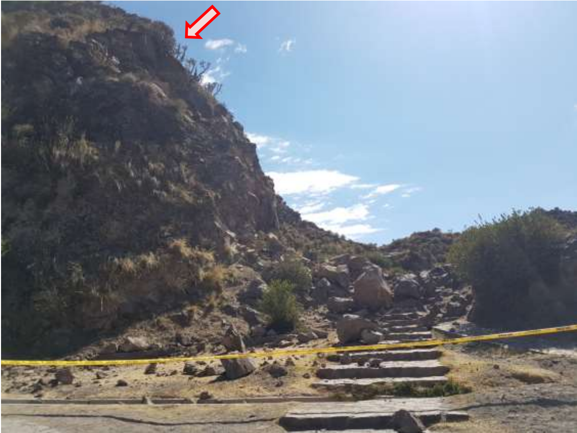
MM01: Caída de rocas.
