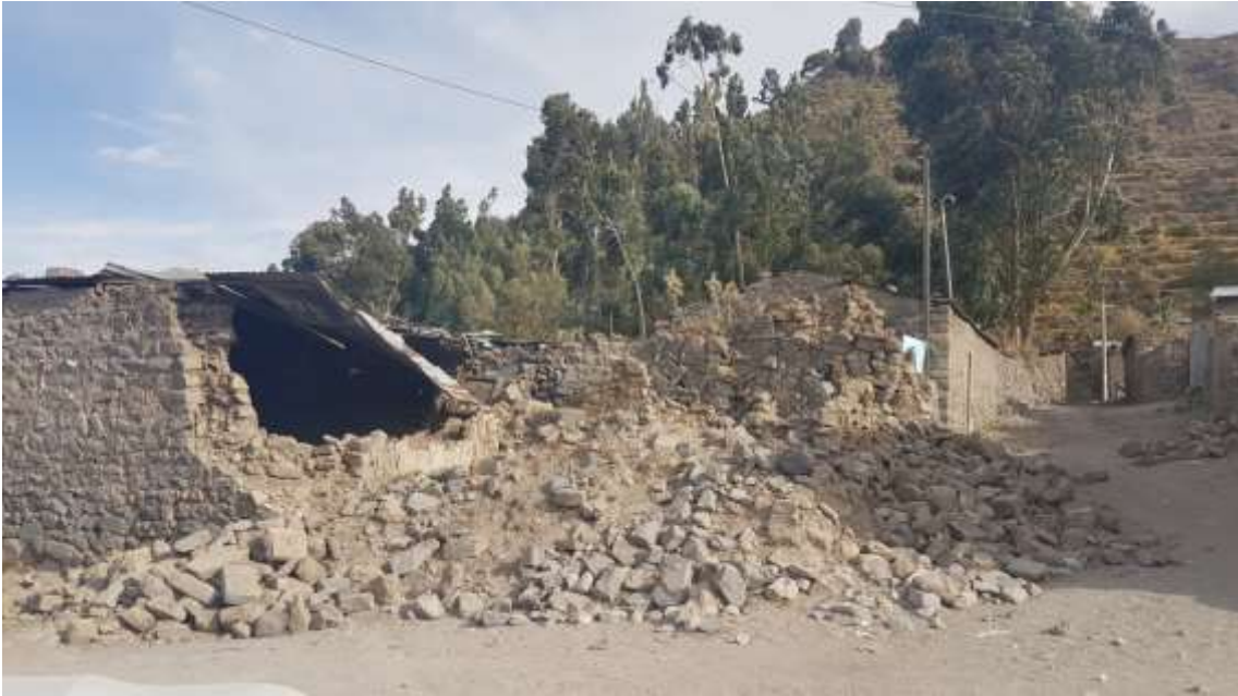
Foto 13: Vivienda colapsada por efecto de la amplificación de ondas sísmicas, el suelo y el tipo de construcción.
