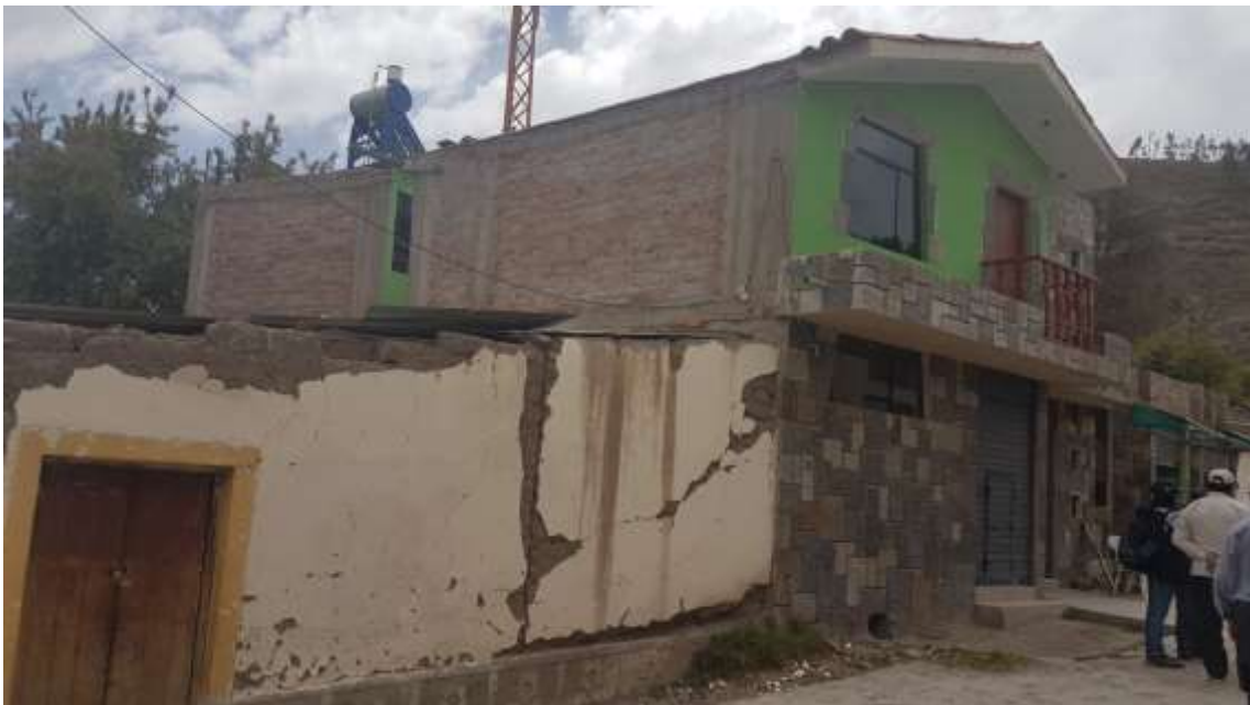
Foto 10: Vivienda de dos pisos de material noble, las paredes y ventanas no sufrieron daños en comparación a la vivienda de adobe que se encuentra continua a esta.
