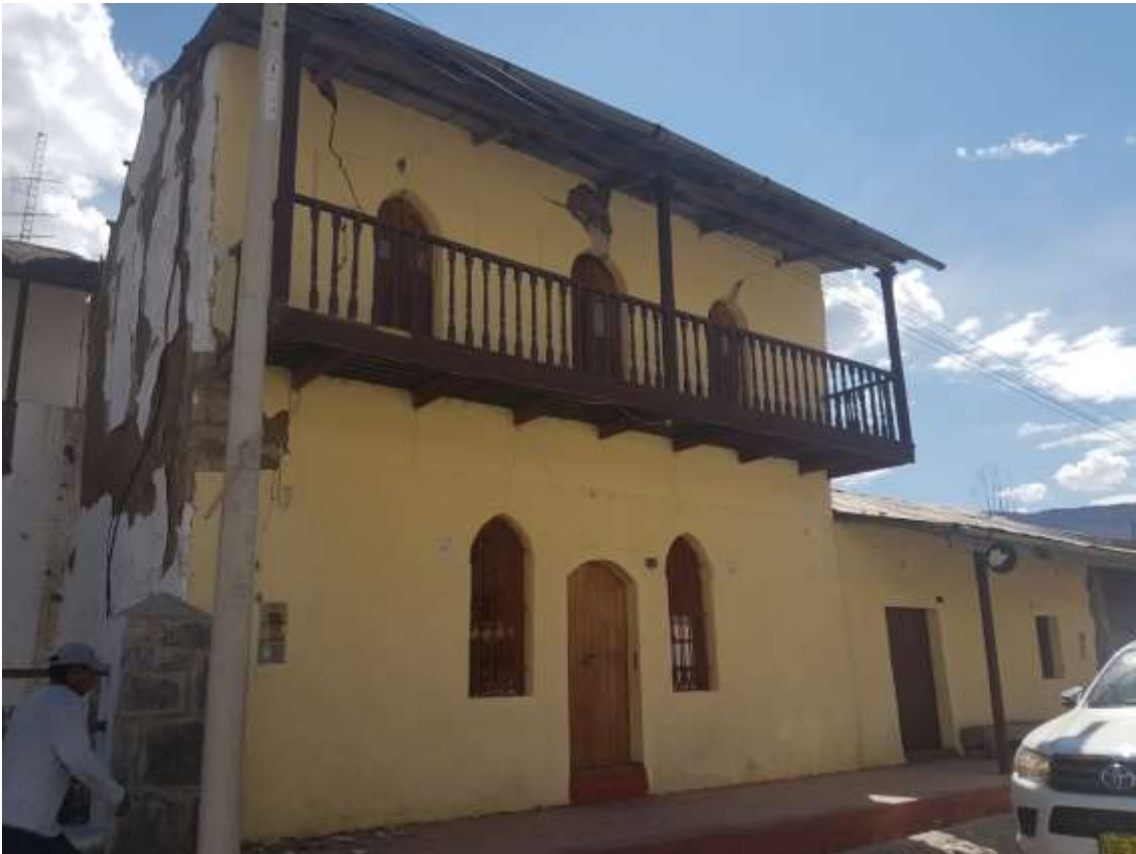
Foto 11: Vivienda afectada, los muros están agrietados por efecto de la amplificación de ondas sísmicas, el suelo y el tipo de material, es considerada una vivienda inhabitable.
