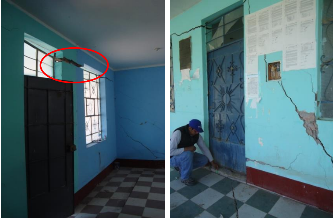
Foto 4. Asentamiento diferencial de 10 cm observado en el local de la municipalidad de Chincho y grietas en todas las paredes.
