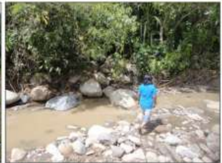
Sector de enrocado, afectado por la erosión fluvial.
