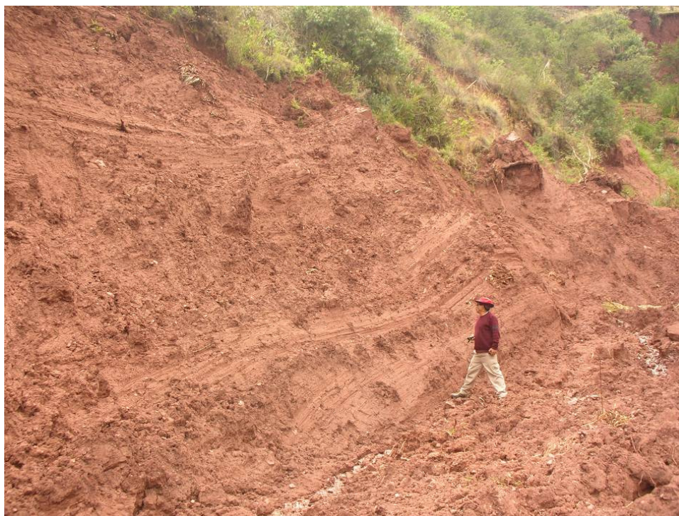
Foto 33. Estrías del flujo F-2 en la margen derecha, en un talud de más de 6 m lo que explica el espesor de la masa de flujo, faltando lo que rellenó la quebrada
