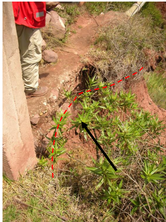
Foto 65. Estribo E-3 del acueducto T-2 con signos de fuerte erosión
