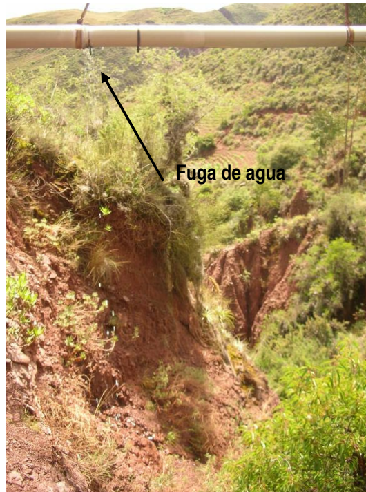
Foto 64. Pequeñas fugas de agua del acueducto T-2
