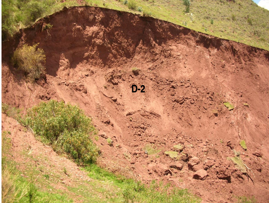
Foto 9. Escarpa D-2 y parte de material deslizado por la última reactivación
