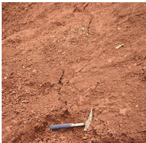
Foto 19. Grietas en la base de talud de la escarpa D-4
