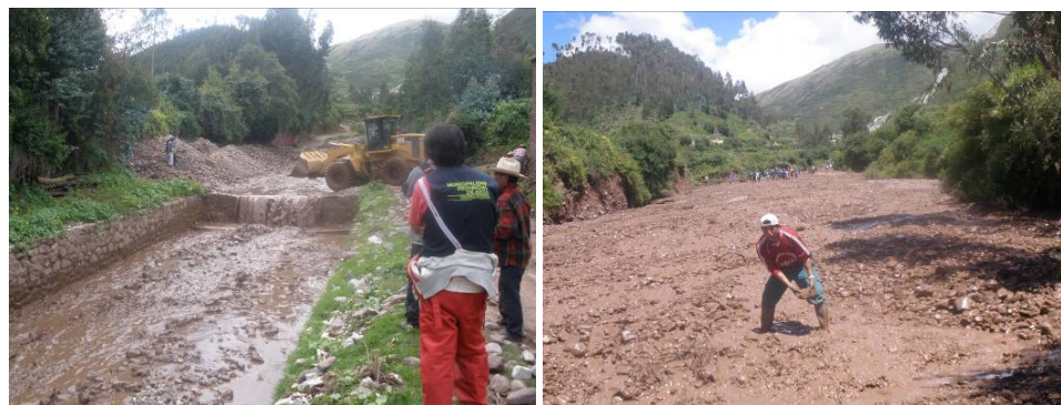
Fotos 27 y 28. Canalización afectada por el aluvión del 28 de enero (izquierda). Destrucción de la canalización tras el aluvión del 6 de febrero (derecha).
