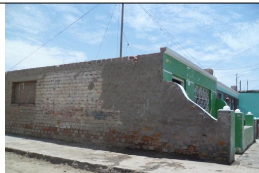
Figura 11. Viviendas de un piso con presencia de humedad en la base.
