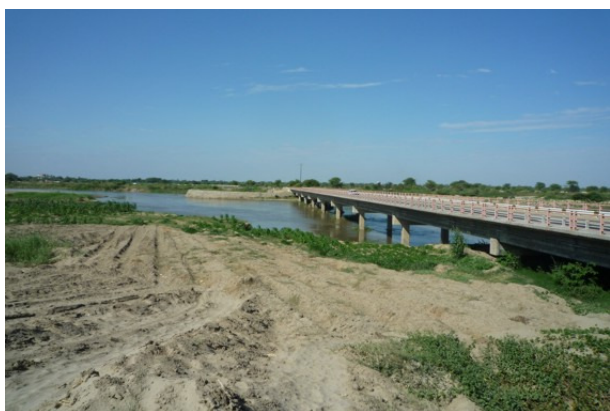
Puente Independencia, vista aguas arriba. En su margen izquierda se han colocado espigones y gaviones para controlar la erosión.
