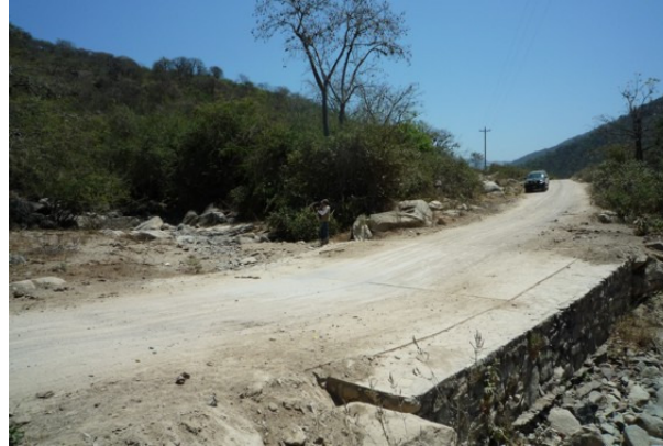
Carretera Chipillico-Sapillica, cortado por flujos de detritos.
