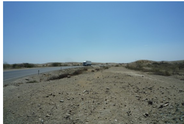
Vista de flujo de detritos en la quebrada Pan de Azúcar, que cortó la carretera Panamericana Norte a la altura del km 65, se ha tenido que variar el tramo.
