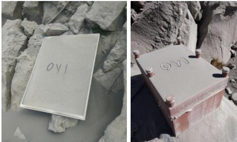
Fotos 5 y 6: Paneles solares y caseta metálica en una estación de monitoreo del Observatorio Vulcanológico del INGEMMET cubierta con ceniza.
