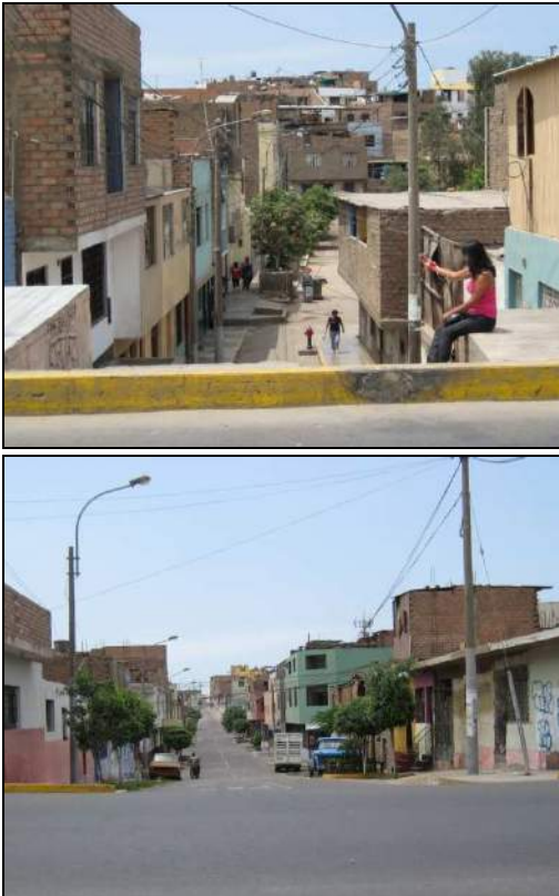
Foto: Las depresiones ubicadas al borde de la av. Morales Duárez con una profundidad de aprox. 5 metros. (Foto izquierda), y a la altura de la cuadra 25 de la Av. Morales Duárez la depresión tiene una profundidad de hasta 2 metros.
