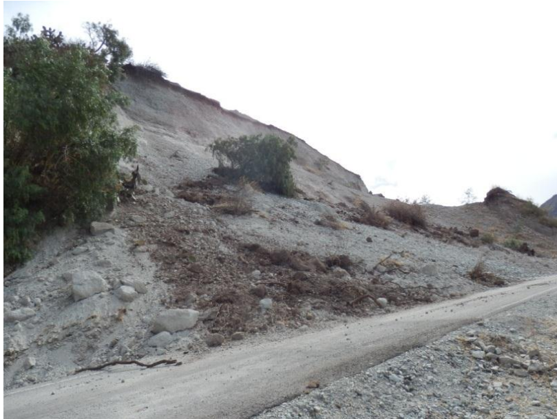
Foto 2: Deslizamiento en la carretera Paruro – Accha, margen derecha del río Apurímac.
