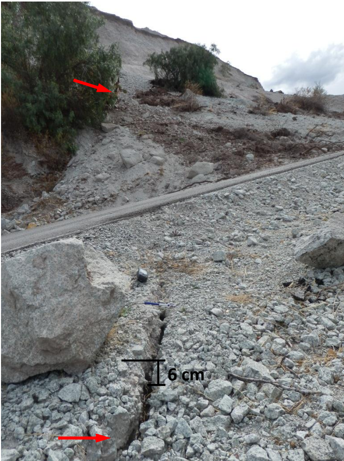
Foto 13: Grieta en la carretera Paruro – Accha, margen izquierda del río Apurímac, presenta una dirección N85°, una abertura máxima de 10cm y presenta un desnivel de 6cm hacia el norte. Se observa que la prolongación de la grieta termina en un deslizamiento.
