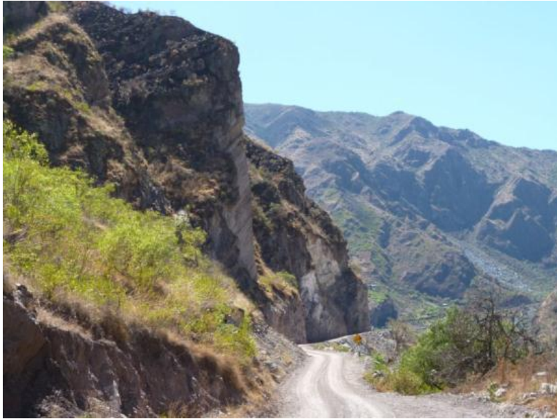
Foto 4: Talud de corte vertical de casi 40 m de altura, muy inestable, desde donde se produce la caída de bloques de roca y suelo.
