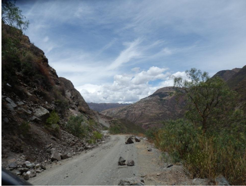
Foto 6: Caída de rocas en tramos de la carretera Cusibamba-Tincoc.
