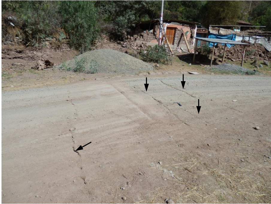
Foto 11: Grieta en el poblado Cusibamba Bajo, tiene una longitud de 25m y afecta la carretera, la dirección principal es N112° y su abertura máxima con 10cm, se observa como las grietas estas en dirección de una vivienda destruida
