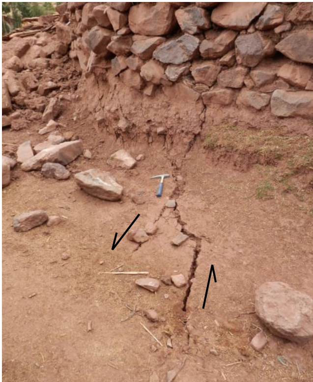
Foto 7: Grieta en el poblado de Misca afectando el camino, un muro y una vivienda, presenta una dirección N65° y una abertura máxima de 10cm.
