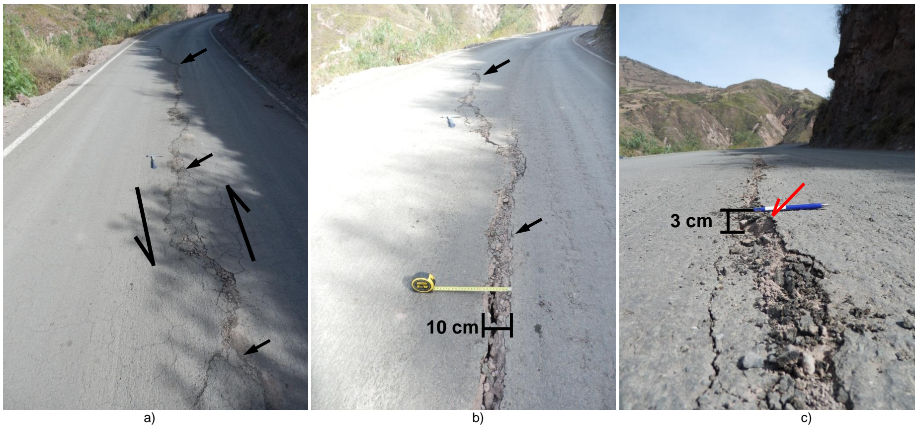
Foto 10: Grieta en la carretera Paruro-Accha, tiene una longitud de 45 m, en a) se muestra el tipo de movimiento y la dirección N152^\circ , b) la abertura máxima es de 10 cm, c) se observa un desnivel de 2.5-3cm, la dirección de movimiento N55^\circ .
