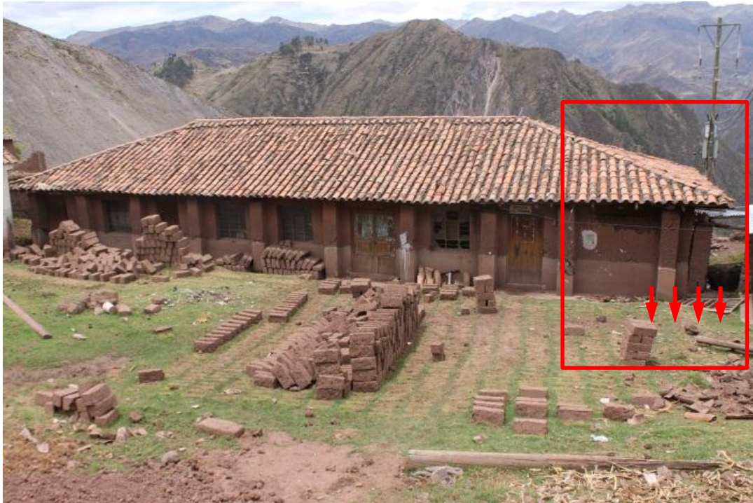
Foto 14: Vista del Salón Comunal de Misca. Se aprecia el buen estado de las paredes y tejado; pero con una observación: En el cuadro rojo se aprecia el agrietamiento y basculamiento del muro, por efecto de deformación en el terreno (Figura 12).
