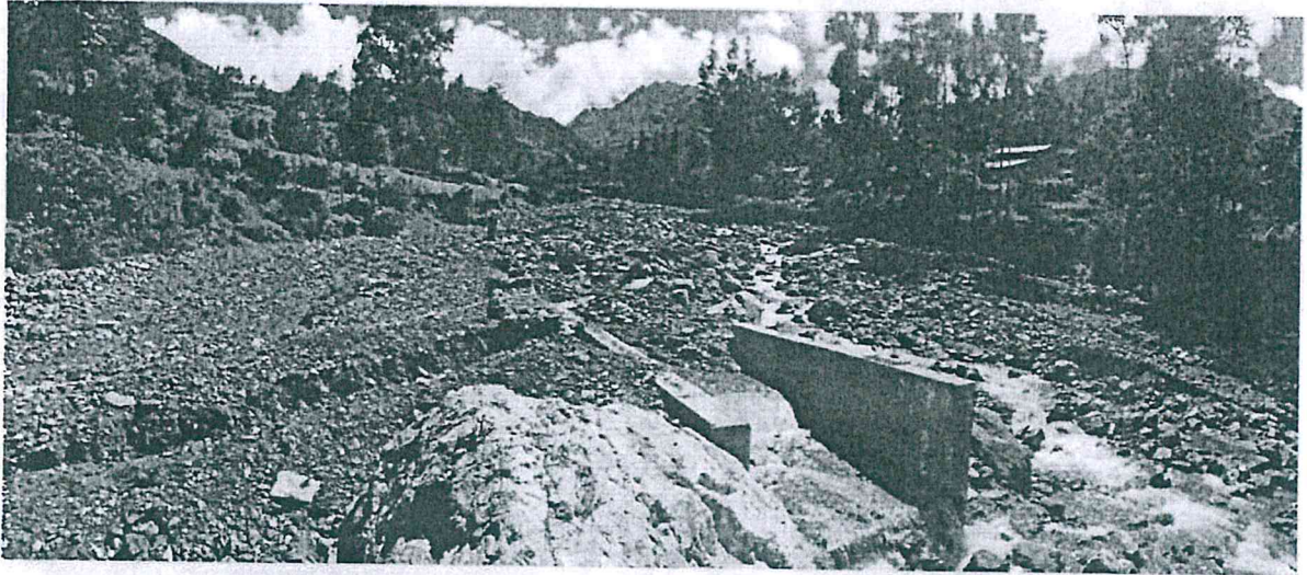
Fotografía 5. Infraestructuras afectada - bocatoma de canal de riego
