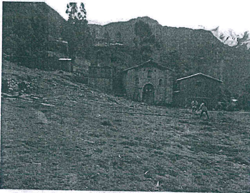
Fotografía 15. Infraestructuras afectada - Iglesia Antigua de material de Adobe y piedra
