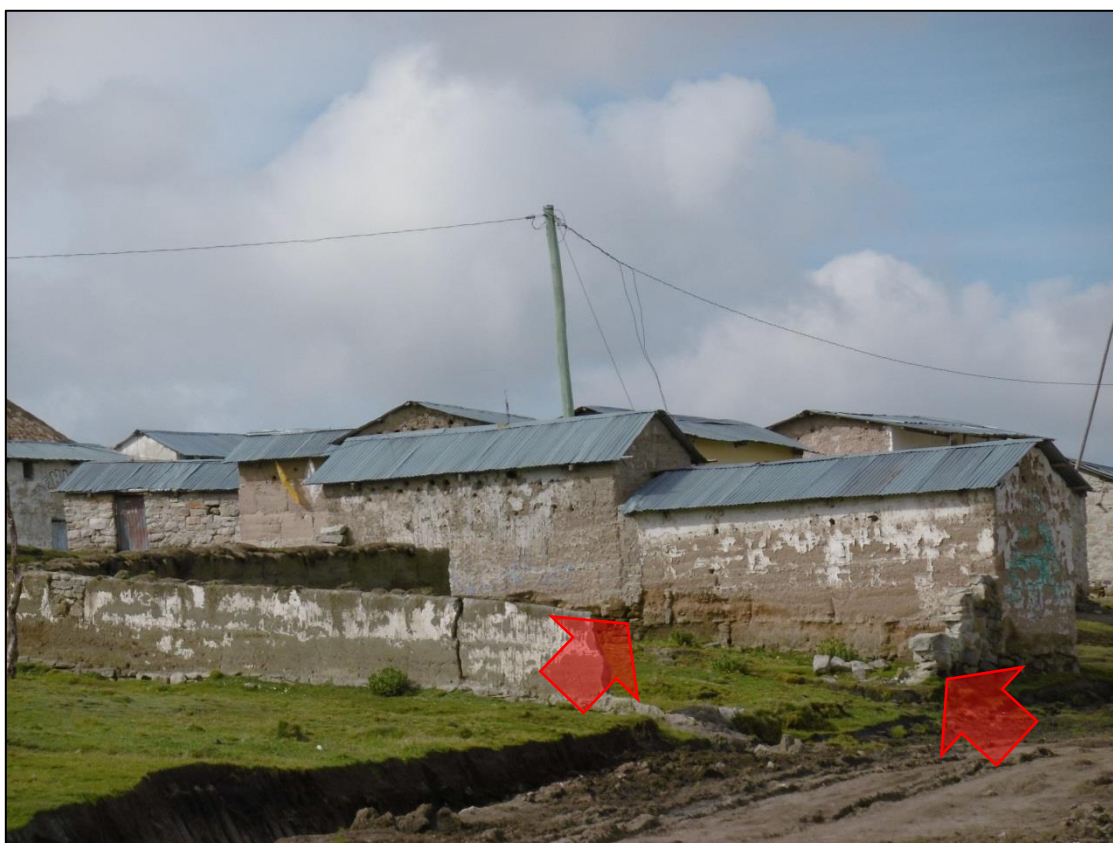
Fotografía 2 – C.P. Socclabamba, se aprecian viviendas en mal estado de conservación, cuyas bases se encuentran carcomidas por la humedad existente en el lugar.
