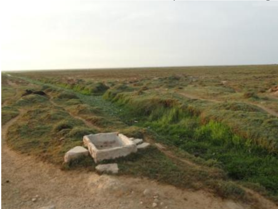
Foto 1.- Disminución de la sección útil de un dren por el crecimiento de vegetación.
