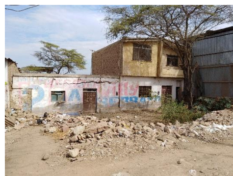
Viviendas inhabitables por la inundación
