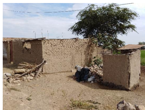
Vivienda de adobe abandonado por la afectación
