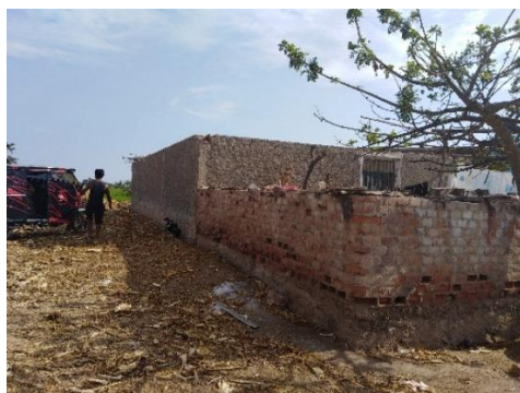
Vivienda de adobe y ladrillo afectado por el agua
