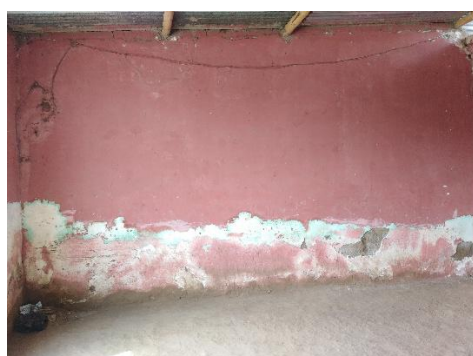
Vivienda afectada e inhabitable por la afectación en sus bases de paredes
