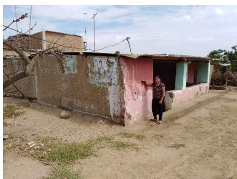
Vista de altura de inundación por las marcas del agua, vivienda inhabitable
