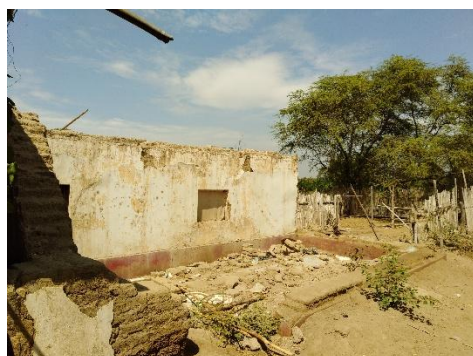
Parte de la vivienda de adobe colapsada (paredes y techo)
