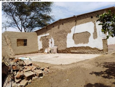
Parte de la vivienda colapsada.
