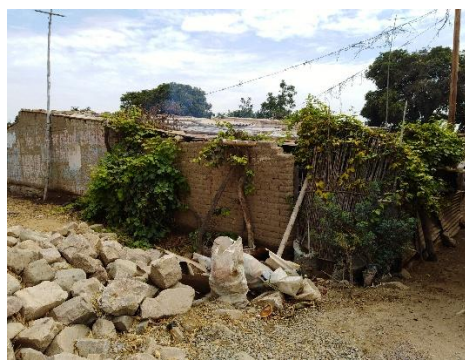
Vivienda colapsada con vegetación
