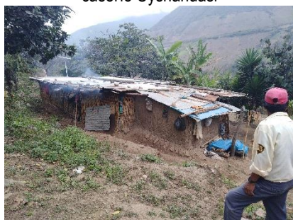
Vivienda afectada por afloramiento de agua en cerro
