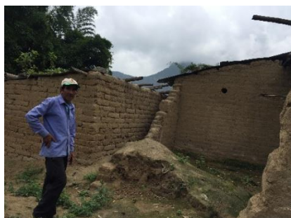
Vivienda inhabitable, ambientes colapsados y paredes en riesgo de colapso en imagen derecha.
