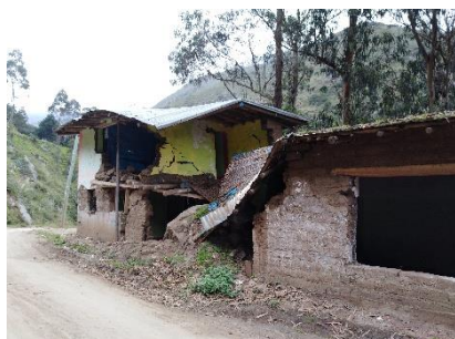
Viviendas inhabitables por caída de rocas en caserío Pagay Puente
