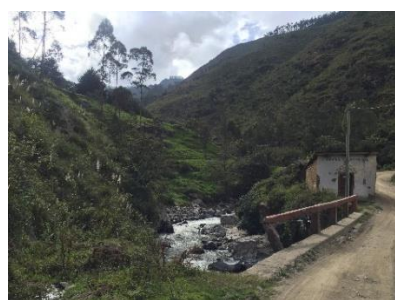
Vista del Caserío Pagay Puente, puente afectado por lluvias
