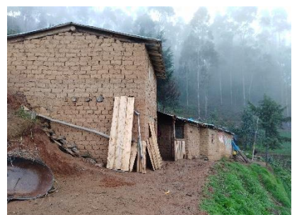
Viviendas afectadas por intensas lluvias en caserío Uyshahuasi
