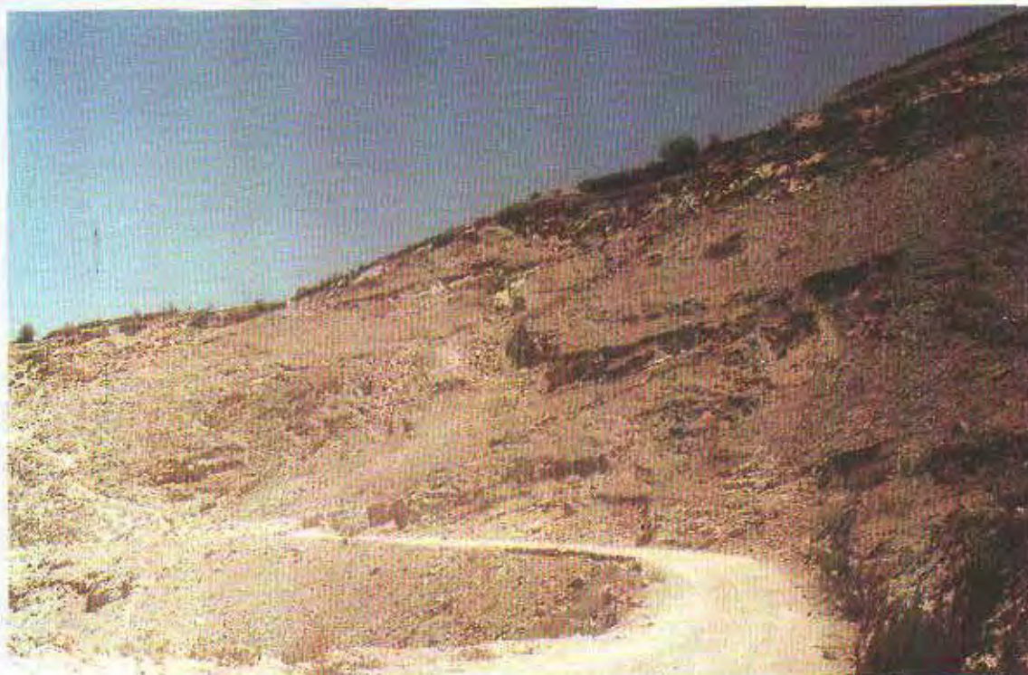
Foto N° 17. Deslizamiento en la carretera Huanca-Taya, sobre el río Pichirijna. Zona crítica.
