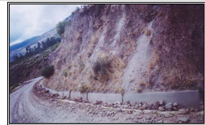
Vía Huanta – Ayacucho (cerca del desvío al Proyecto Razuhuilca). Requiere afianzar el sistema de drenaje construyendo zanjas de coronación por encima de los taludes y mejorando las obras de drenaje ya existentes, en particular aquellas que por su escasa capacidad no son suficientes para coleccionar las aguas de escorrentía superficial provenientes de las laderas y terminan ocasionando daños importantes en la vía o en centros poblados ubicados aguas abajo durante época de lluvias intensas.
