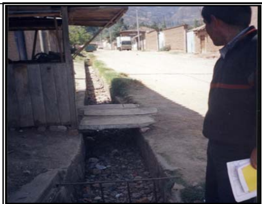
Canal de drenaje del Jr. Zarumilla, colmatado y con falta de mantenimiento
