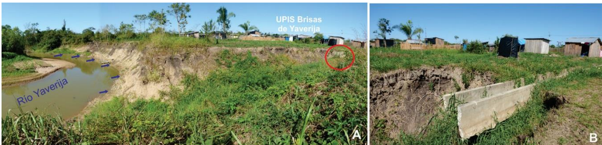
Foto 16. A) Erosión fluvial en la margen izquierda del río Yaverija, aquí se encuentra asentado la UPIS Brisas de Yaverija. En enero del 2014 incrementó el caudal del río desbordándose hasta la Av. José Olaya (80 m) afectando aproximadamente 30 viviendas, la zona también es afectada por cárcavas debido a la intensa erosión originado por la evacuación de un colector de drenaje pluvial mal diseñado identificado con el círculo de color rojo . B) Vista más cercana del colector de drenaje pluvial.
