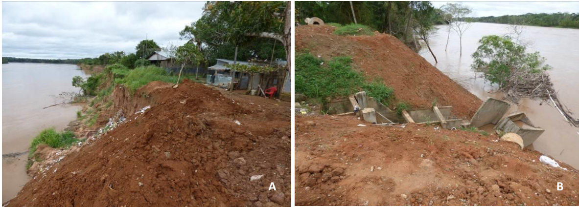
Foto 3. Vistas de la erosión fluvial en la margen izquierda del río Tambopata, en una extensión de 1100 m, como se observa en (A) las viviendas se encuentran de 8 a 35 m de distancia hacia el borde del río, (B) debido a la constante erosión y a la intervención del hombre, colapsó un colector construido para evacuar el drenaje de precipitaciones pero los pobladores de la zona lo usaron como desagüe, acelerando el proceso de erosión.
