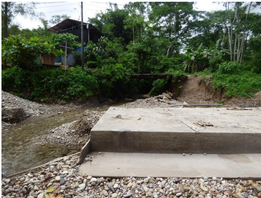
Foto 8. Vivienda que debe ser reubicada y badén que necesita una mayor longitud.
