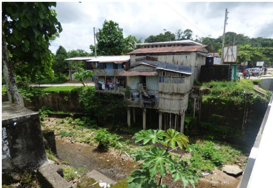
Foto 6. Vivienda construida dentro del cauce natural del río Huipoca.
