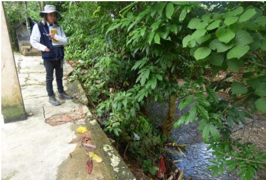
Foto 7. Erosión en la margen izquierda del río Huipoca, dónde se observa un muro con agrietamientos originado por la socavación en su base.
