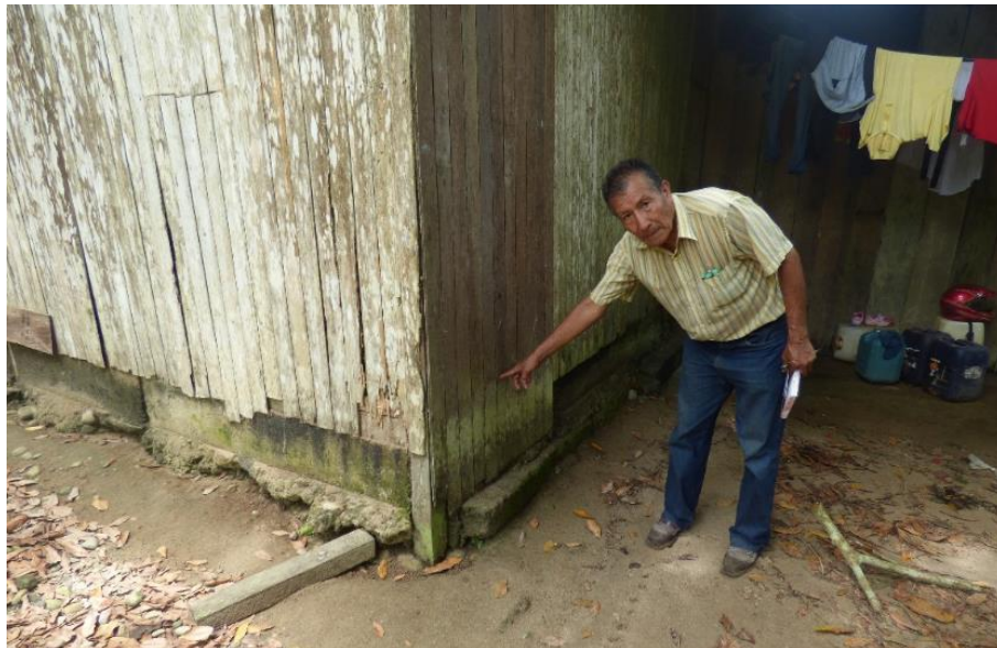
Foto 4: Altura de la inundación de aproximadamente 50 cm por desborde del río Huipoca.
