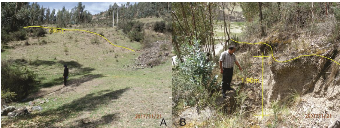
Fotografía 6 Vista A) Ladera con pendiente entre 5°-15° donde se presentan agrietamientos (línea amarilla), salto vertical de 0.60 m; B) ladera coluvial formada por clastos con matriz limosa; también se observa agrietamiento con salto vertical de 1.9 m en línea amarilla.
