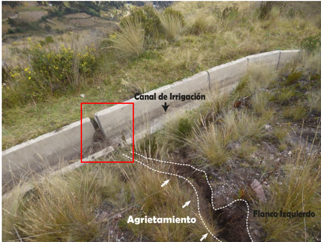
Foto 7: La prolongación del agrietamiento en el flanco izquierdo afecta la infraestructura del canal de irrigación.
