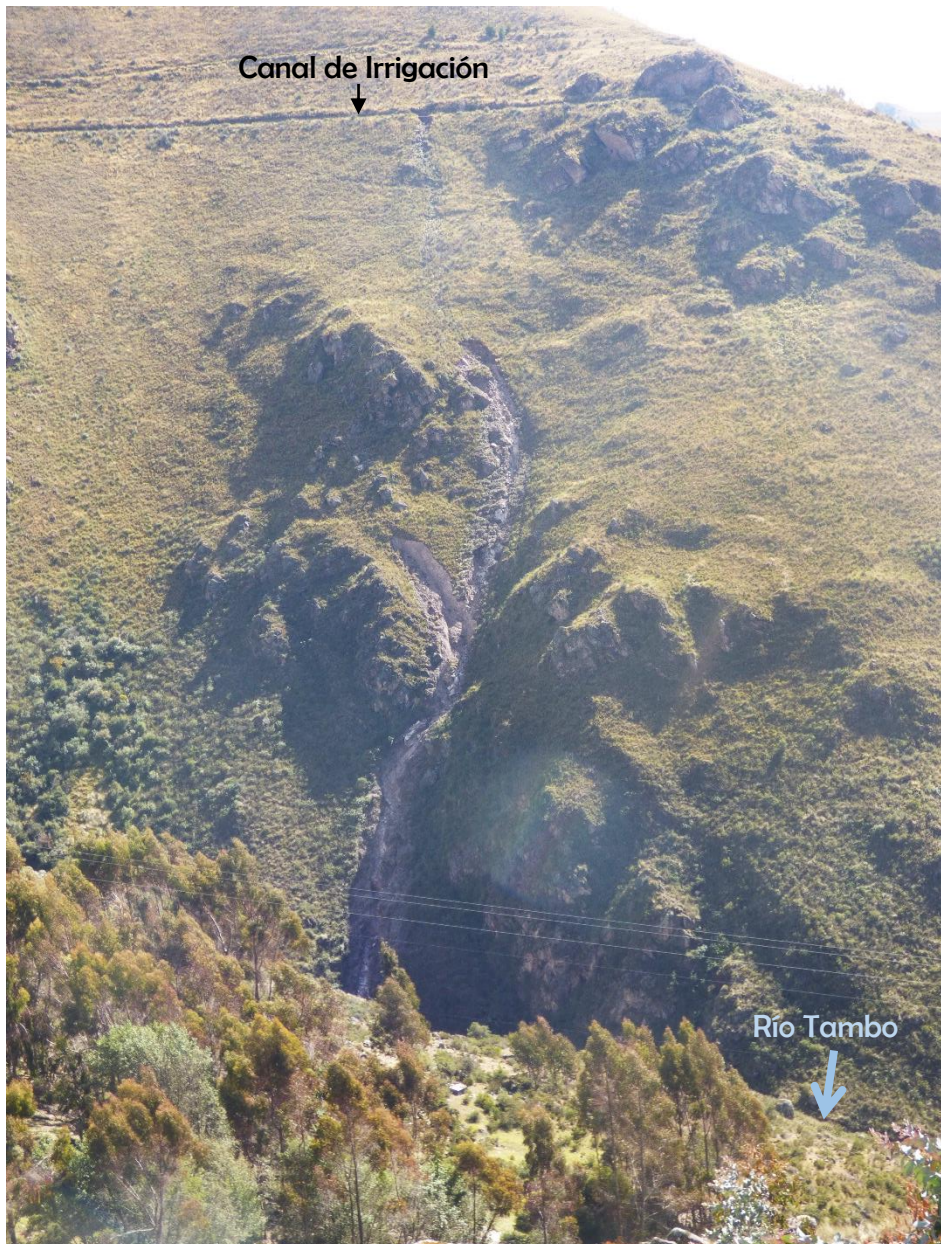
Foto 3: Vista de deslizamientos y cárcavas que afectan el canal de irrigación.
