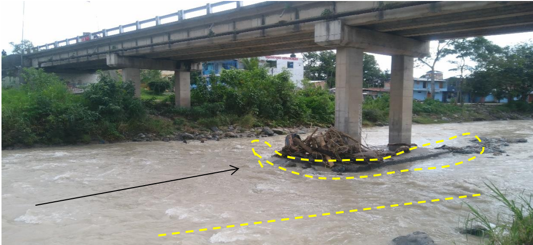
FOTO N° 15: Se muestra el lecho principal del río (línea celeste) y el socavamiento en el pilote central del puente Yuracyacu (línea amarilla).
