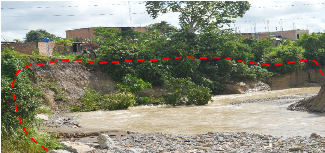
FOTO N° 17: Se muestra la erosión fluvial (245116.483E, 9343153.360 N) viviendas ubicadas en la franja ribera, la línea de color rojo muestra el nivel de la fuerte erosión por eventos de precipitaciones intensas.
