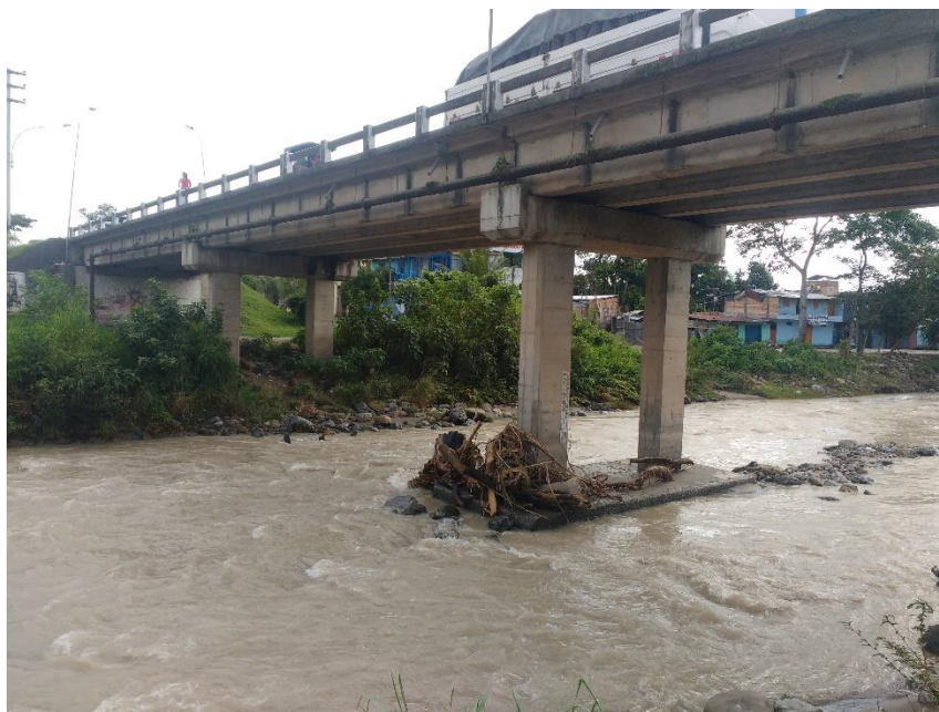
Foto N ° 07: Puente Yuracyacu en peligro por erosión
