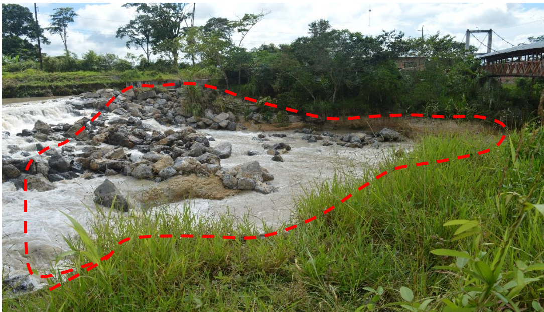
FOTO N° 18: Se muestra el nivel de erosión y remoción del bloque de rocas en la bocatoma del canal morito (ref. puente José Olaya).
