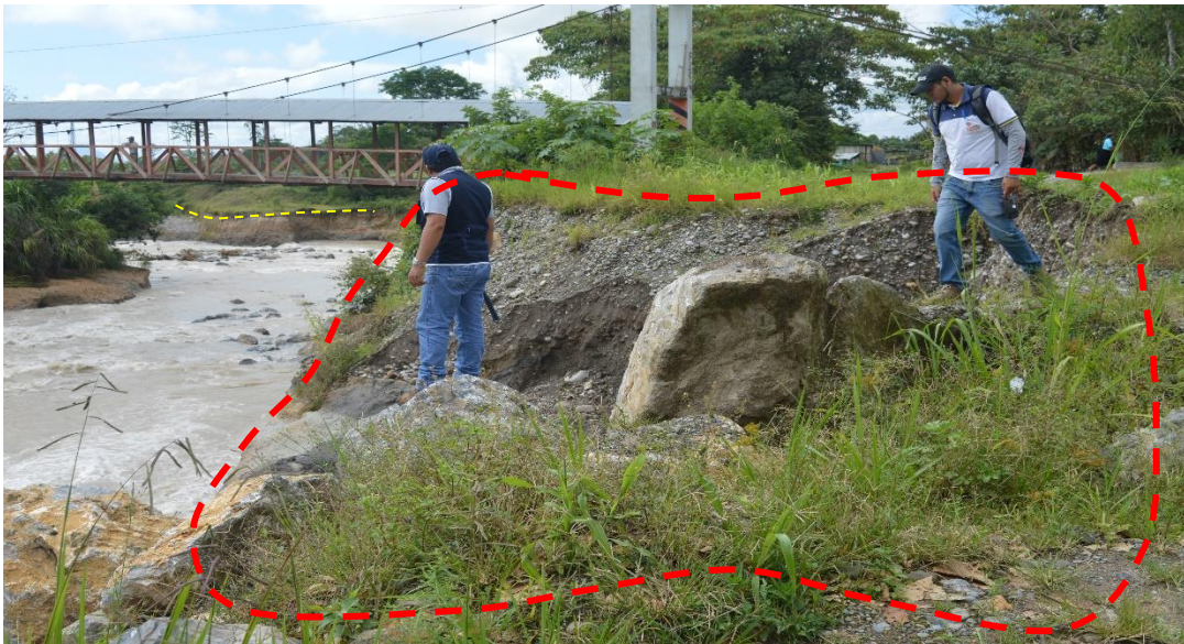
FOTO N° 16: Se muestra el nivel de erosión alta a pocos metros del puente José Olaya.
