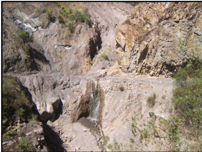
Foto 24.- Flujo que se genera en la quebrada Llocche, en tiempos de lluvia afecta a carretera.
