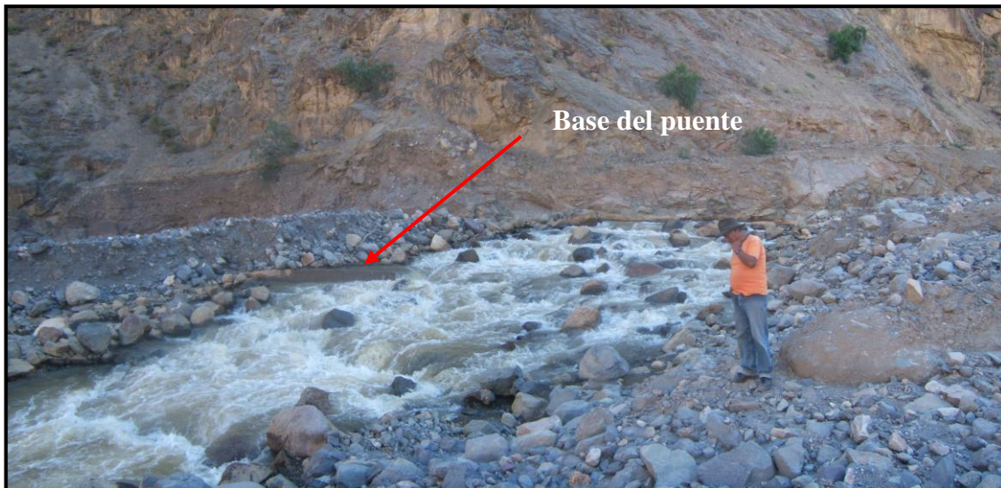
Foto 20.- Vista de parte del estribo derecho del puente que fue destruido por el flujo que bajo por la quebrada Tumac.
