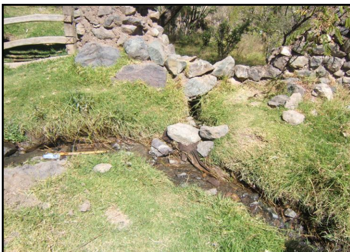
Foto 12.- Canal principal de regadío sin revestir.
