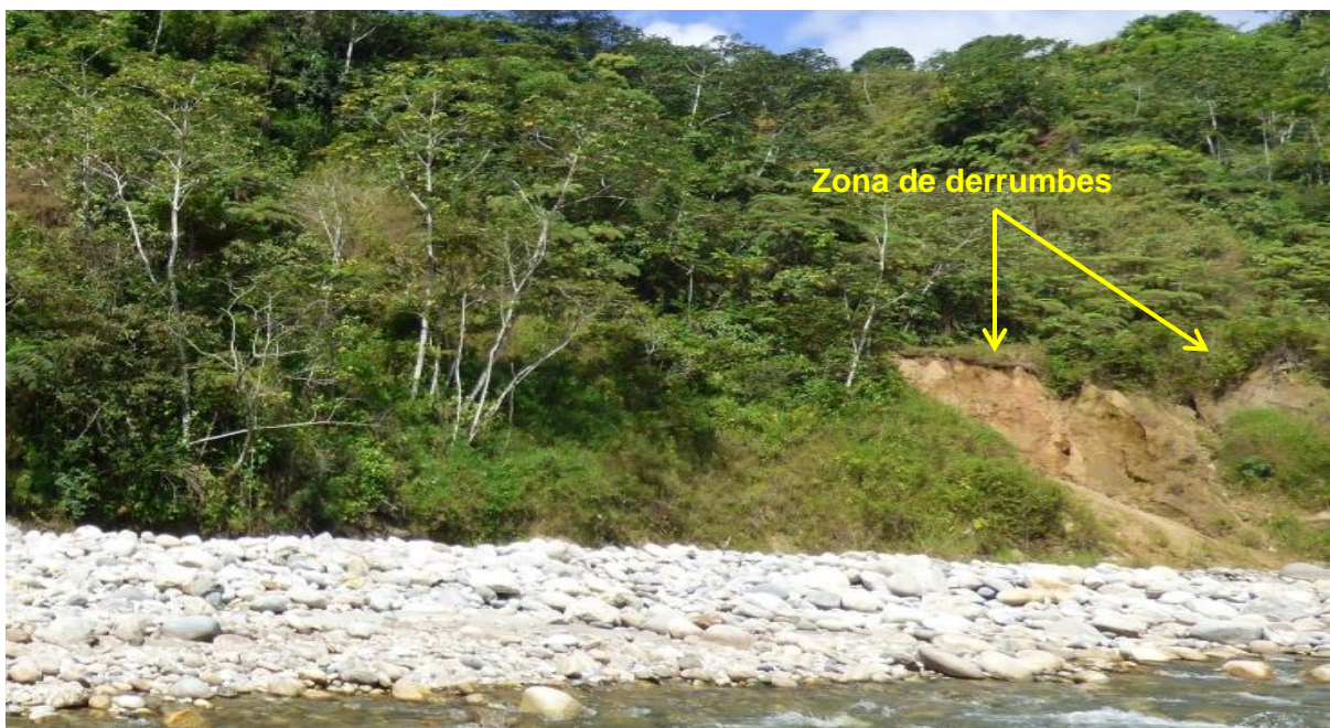
Foto 14: Derrumbes generados por la erosión fluvial.
