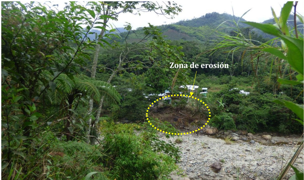
Foto 7: Erosión fluvial en la margen izquierda del río Pampa Hermosa.
