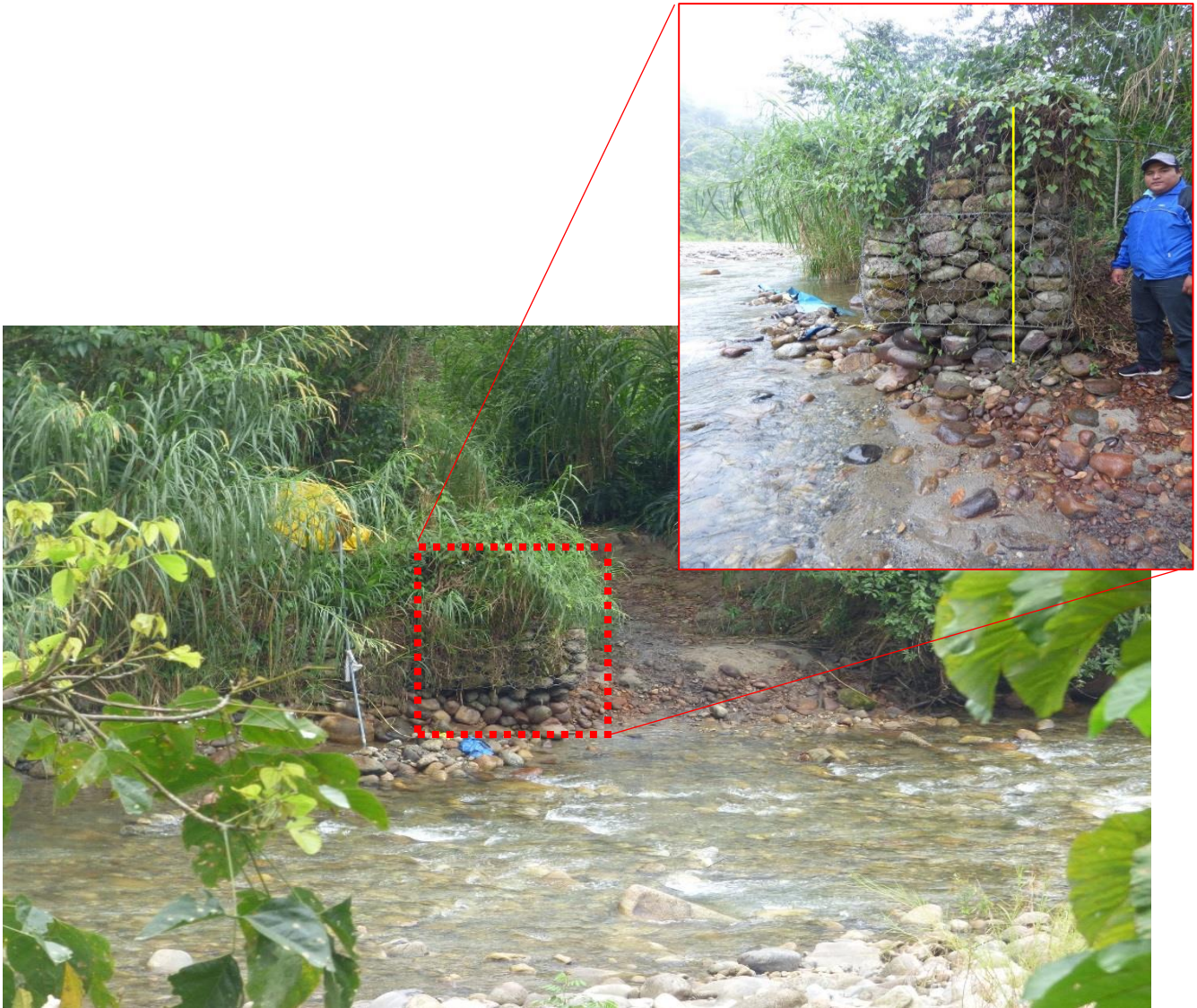
Foto 10: Vista de un Gavión destruido en la margen izquierda del río Pampa Hermosa,
