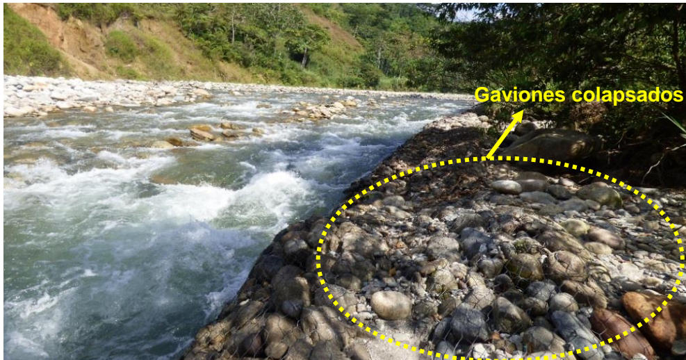
Foto 15: Vista de Gaviones colapsados.
