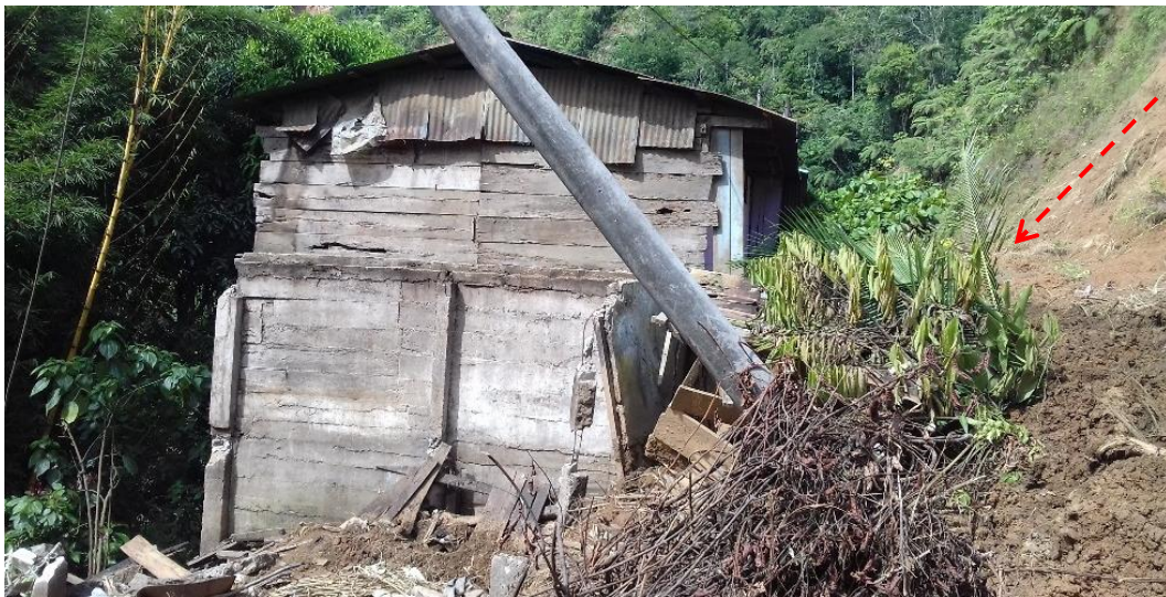
Foto 19: Vivienda destruida y poste de energía eléctrica afectado. Foto Municipalidad de Pampa Hermosa.
