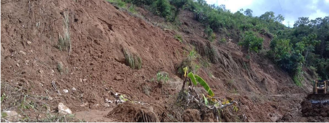
Foto 3: Depósito coluvial, a lo largo de la carretera antigua Satipo-Huancayo (Foto de la municipalidad de Pampa Hermosa).
