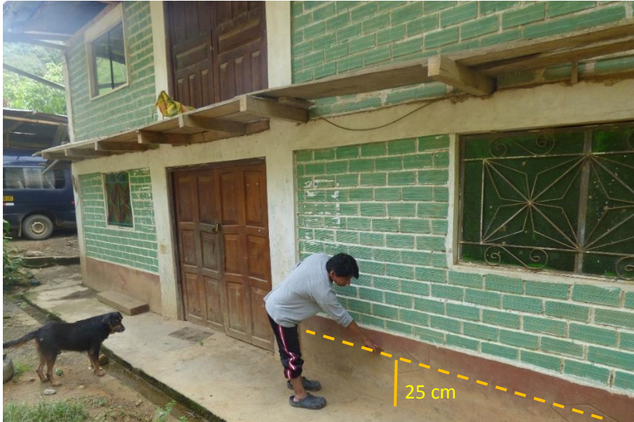
Foto 13: se muestra la altura que alcanzo el flujo de lodo en el sector San Dionicio a 100 m de la quebrada principal (b) (Mancha en la pared de vivienda).
