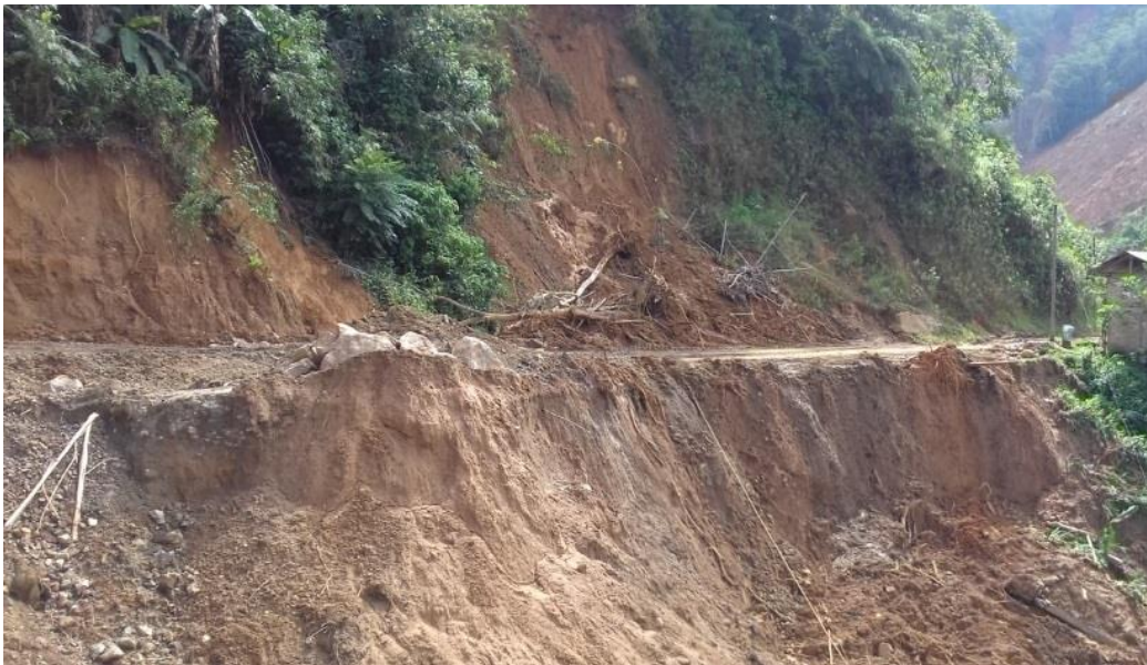
Foto 26: Derrumbes que afectan la vía Satipo-Huancayo (antigua carretera). Foto Municipalidad de Pampa Hermosa.
