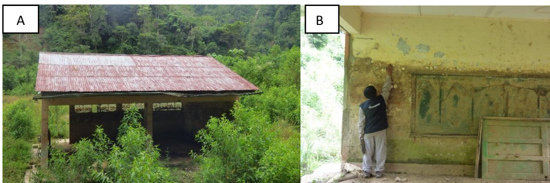
Foto 10: Vista exterior de la escuela San Dionicio totalmente afectada (A). Se observa la parte interior de la escuela San Dionicio y la altura que alcanzó el flujo de lodo (B).
