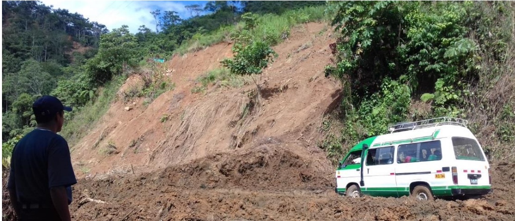
Foto 16: El material desplazado llegó a destruir una vivienda y un tramo de la carretera. Foto Municipalidad de Pampa Hermosa 2016
